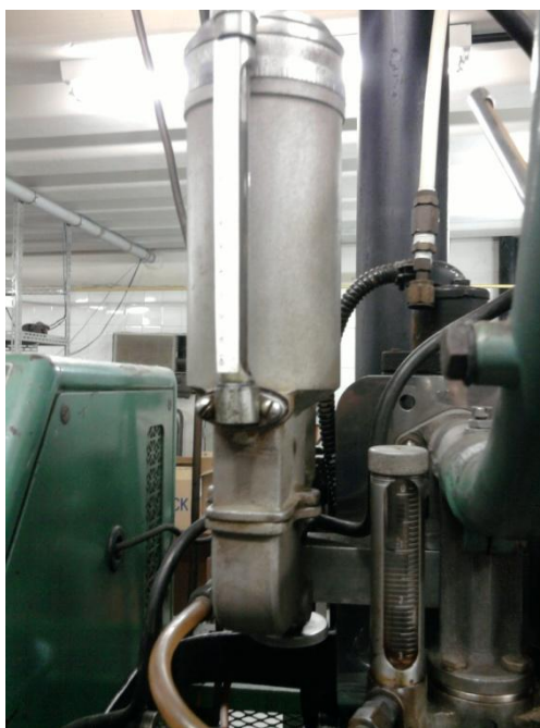
Figura 4.6 - Reservatório de combustível e visor de vidro do nível de altura da cuba de combustível
