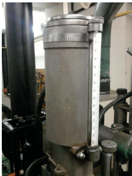
Figura 4.8 - Escala do nível do reservatório de combustível
