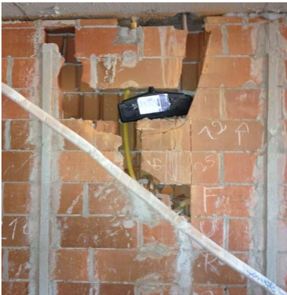
Figura 32: Incompatibilidade de projetos – quebra-deira da parede (Foto tirada pelo autor)
