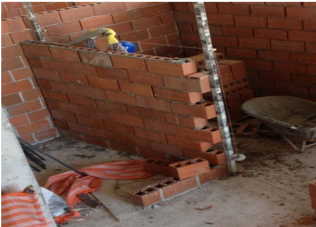
Figura 28 – Elevação da alvenaria com utilização do escantilhão e da bisnaga para assentamento dos blocos (Foto tirada pelo autor).
