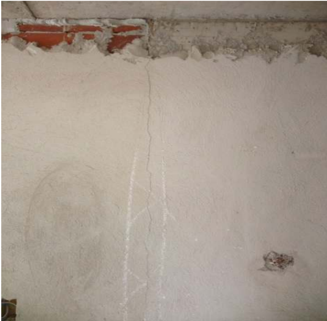
Figura 29: rachadura no encontro da alvenaria com estrutura (Foto tirada pelo autor).
