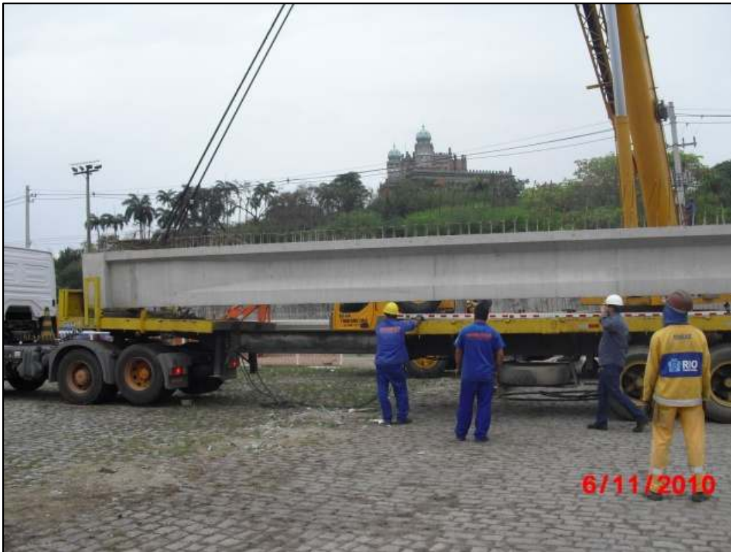
Fig101. Transporte da viga do canteiro central ao local da obra através da carreta extensiva
