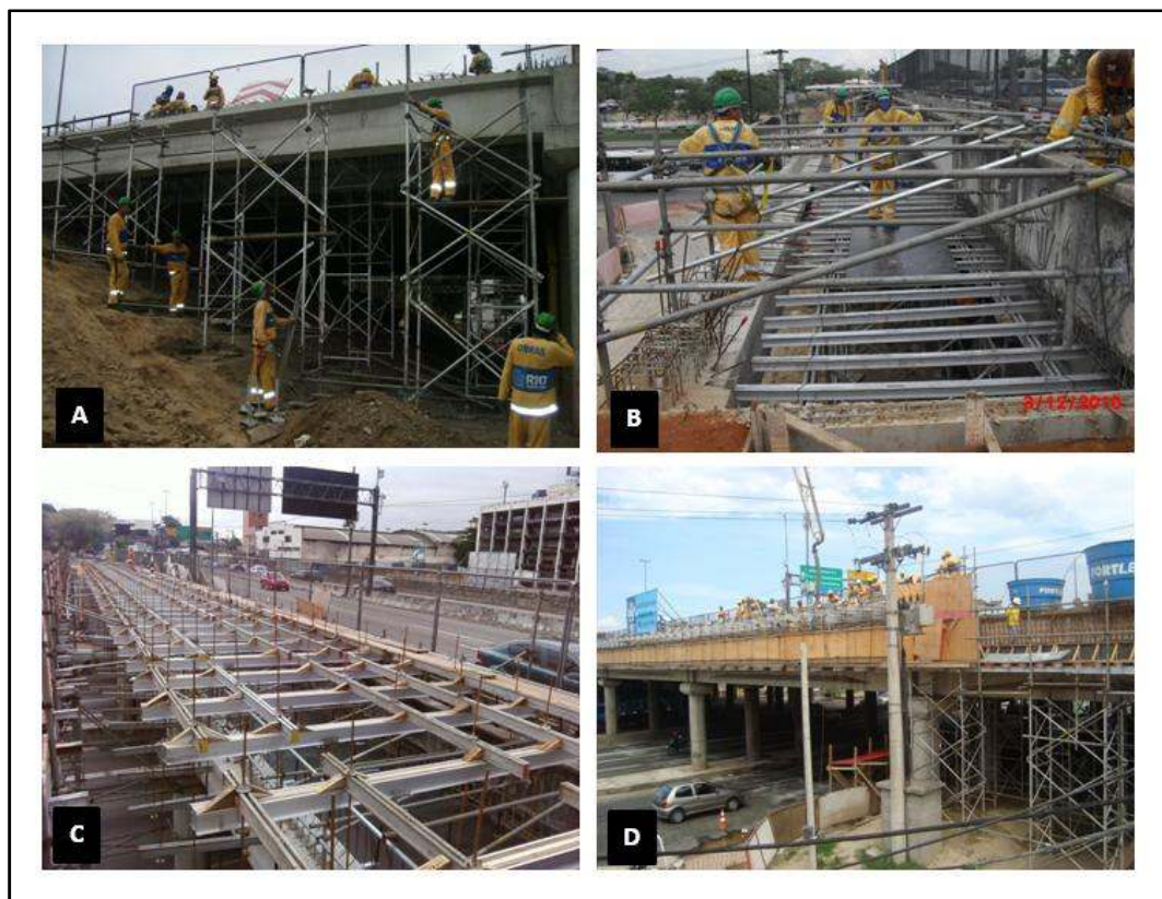
Fig78. Figura A – Montagem do escoramento convencional fixo. Figura B – Montagem da forma sobre o escoramento convencional fixo. Figura C – Montagem do escoramento suspenso. Figura D – Concretagem da pré-laje com concreto bombeado. Fonte: Autor
