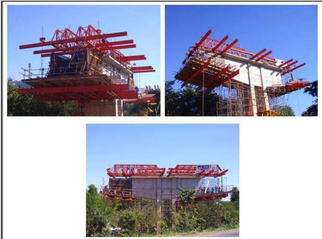
Fig13. Execução do Balanço Sucessivo em ponte com aduelas moldadas no local - Rio Santa Luzia (M-150) Ferrovia Norte Sul – SPA Engenharia Fonte: Apresentação cedida pela empresa Mills
