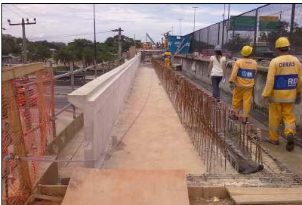
Fig105. Guarda-corpo da passagem de pedestre a esquerda já concretado e montagem da armadura da barreira New Jersey a direita.
