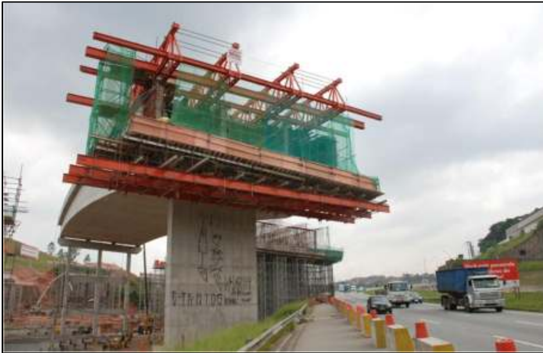
Fig11. Execução do Balanço Sucessivo em viaduto com aduelas moldadas no local - Rodoanel – OAE 517 – PE - (Aspem) - Embú/SP – Construtora OAS Fonte: Apresentação cedida pela empresa Mills
