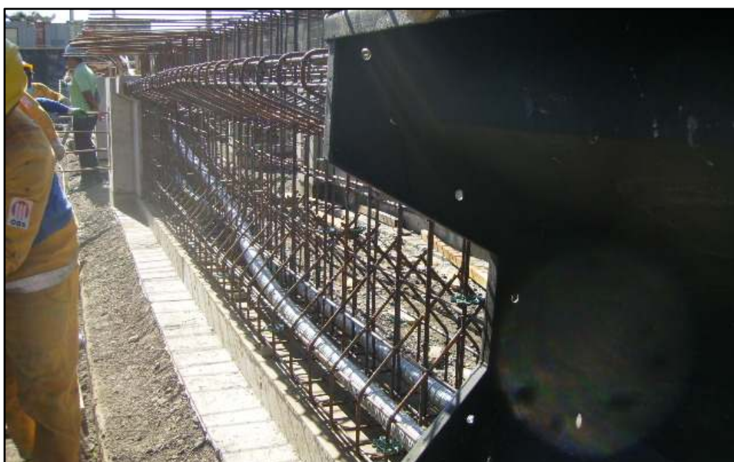
Fig93. Passagem da bainha de protensão no meio da armadura no local devido de projeto para posterior passagem dos cabos e protensão
