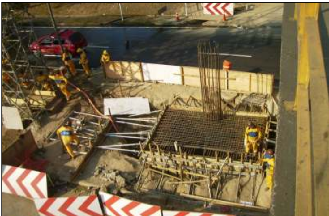
Fig81. Armação e fôrma do bloco B6 com espera da armadura da primeira etapa do pilar 6
