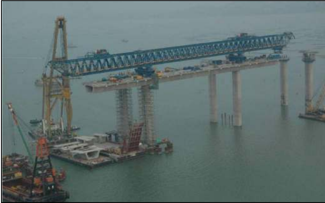
Fig1. Execução de Balanço Sucessivo em ponte com aduela pré-moldada Fonte: Bridge Construction Methods By David Trayner
