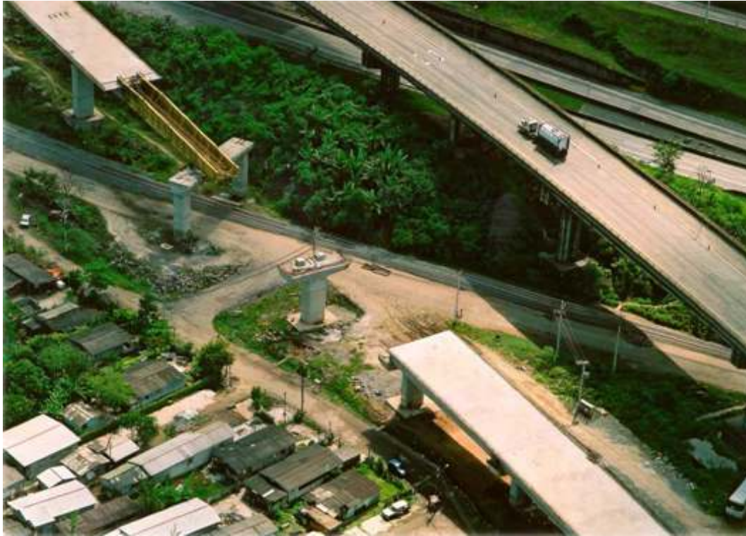
Fig21. Execução de método de Empurramento Sucessivo. Obra Duplicação da Rodovia dos Imigrantes – São Paulo – Concessão Ecovias Fonte: ECOVIAS
