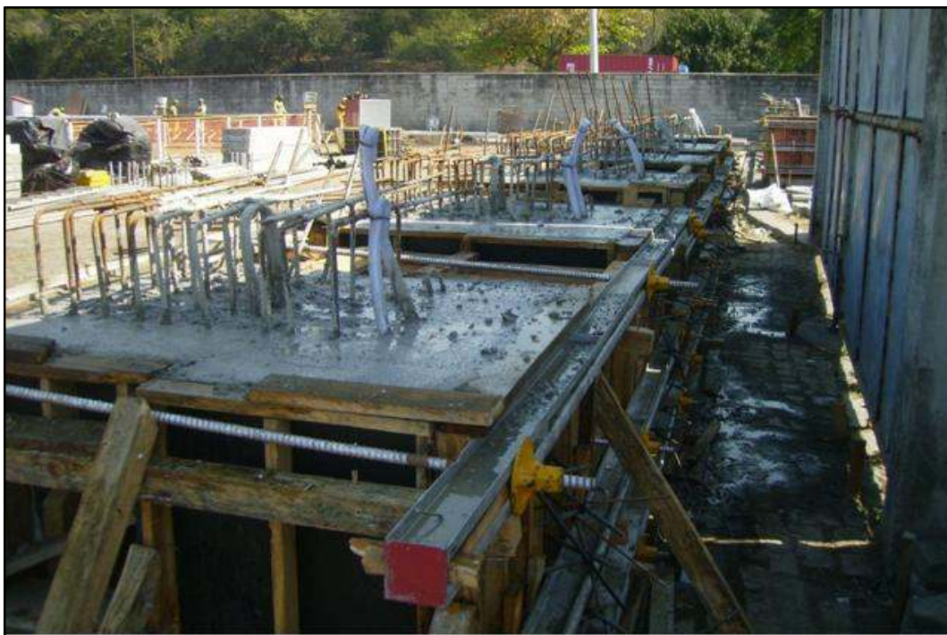
Fig89. Cabeça da viga já concretada. Detalhe para a armadura de espera da transversina
