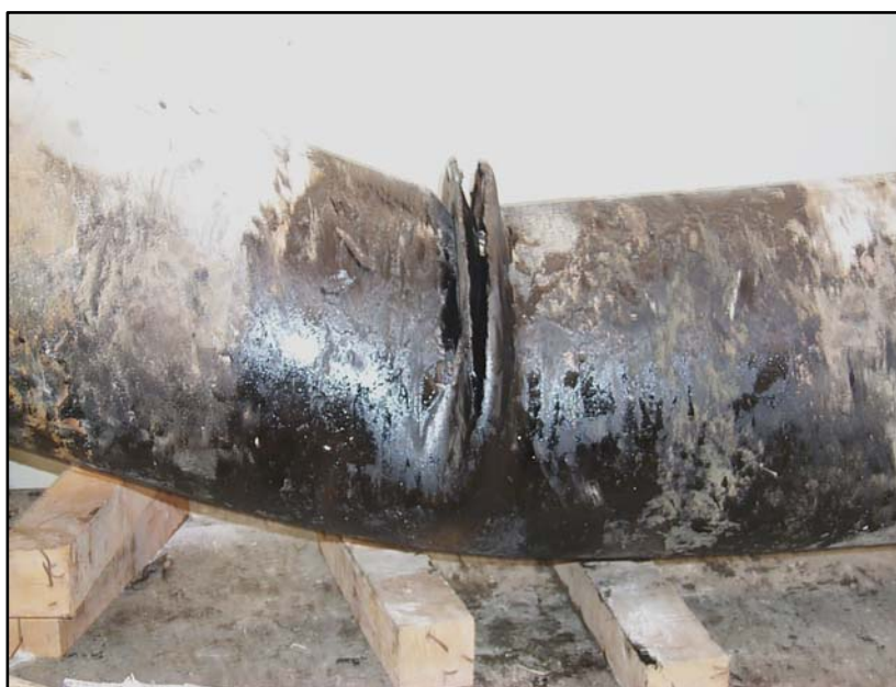
Figura 1 – Local da Ruptura no duto PE-II.
