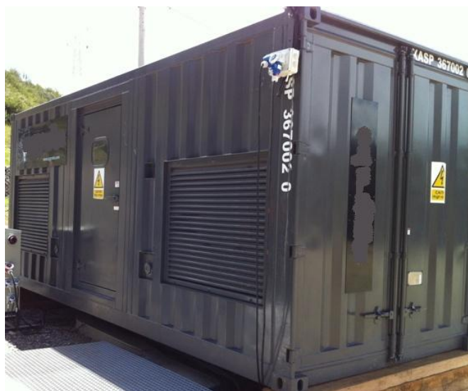
Figura 4.1: Imagem de um Típico Container de Geração a Diesel
