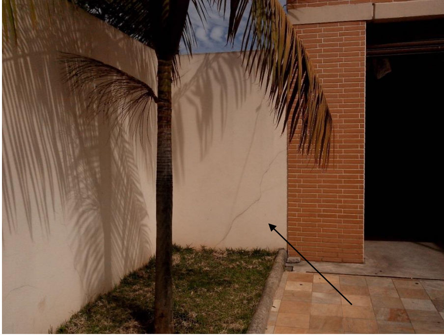
Figura 3.26 - Rachadura na fachada externa (lado 2).
