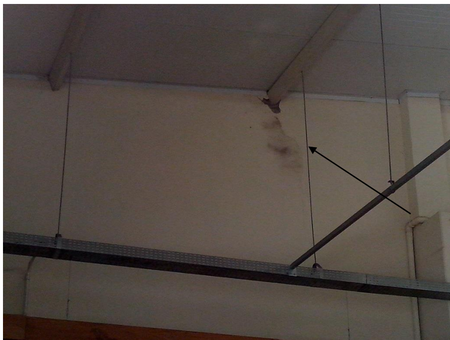
Figura 3.37 - Rachadura na parede interna da loja (lado 1).
