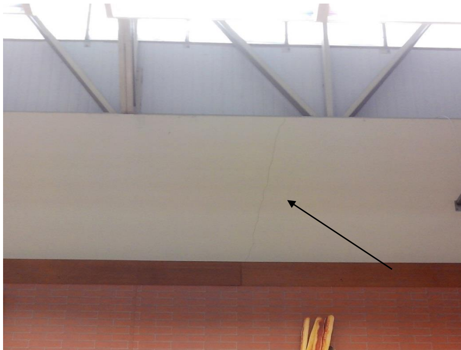
Figura 3.36 - Rachadura na parede interna da loja (lado 3).
