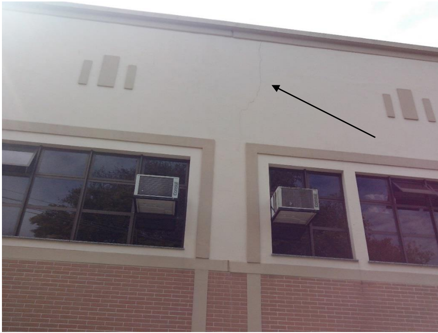
Figura 3.24 - Rachadura na fachada externa (lado3).
