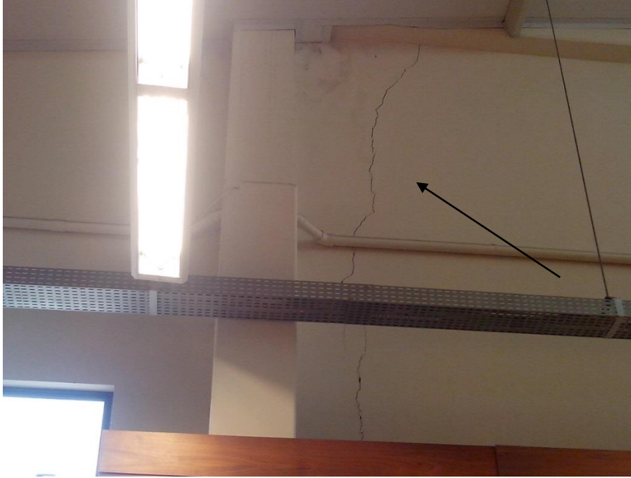
Figura 3.34 - Rachadura na parede interna da loja (lado 4).
