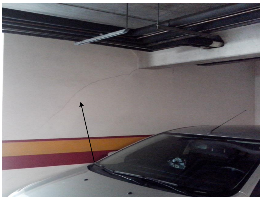
Figura 3.29 - Rachadura na parede interna do estacionamento (lado 4).
