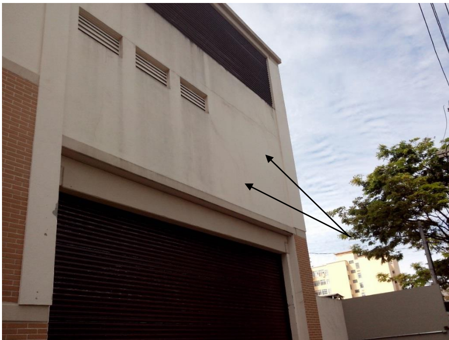
Figura 3.25 - Rachadura na fachada externa (lado3).
