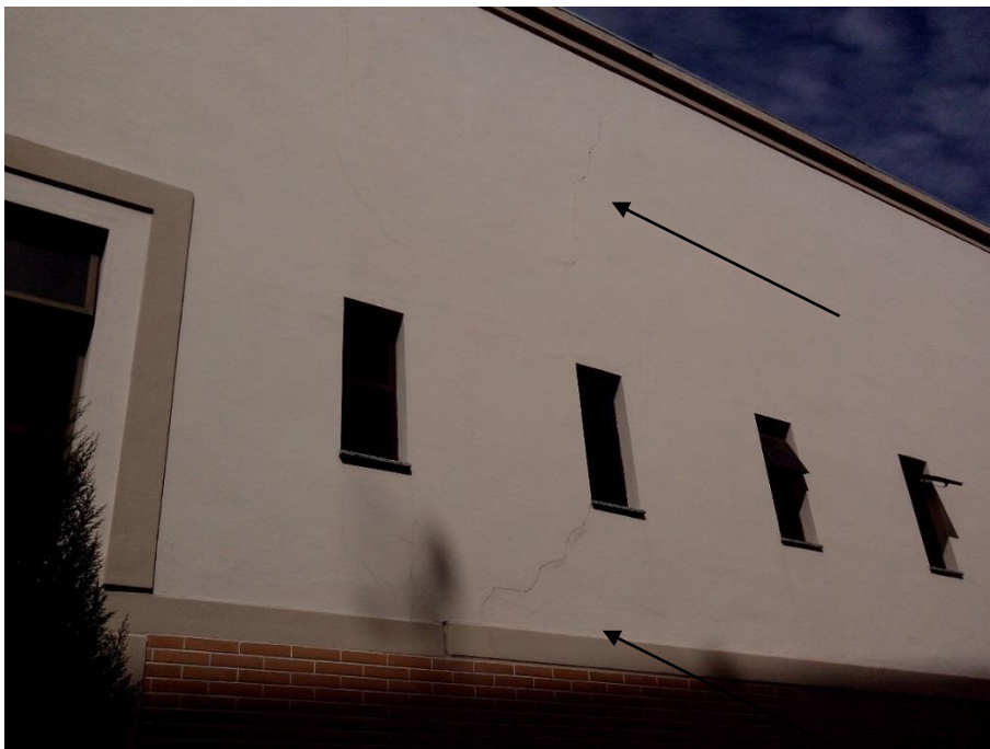
Figura 3.39 - Rachadura na fachada (lado 1).
