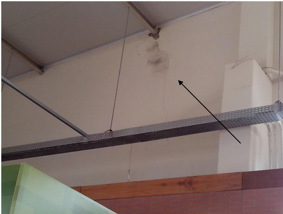
Fotografia 3.31 - Rachadura na parede interna da loja (lado 4).
