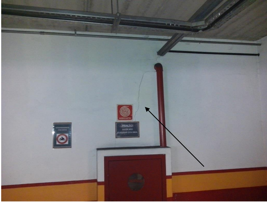
Fotografia 3.30 - Rachadura na parede interna do estacionamento (lado 3).
