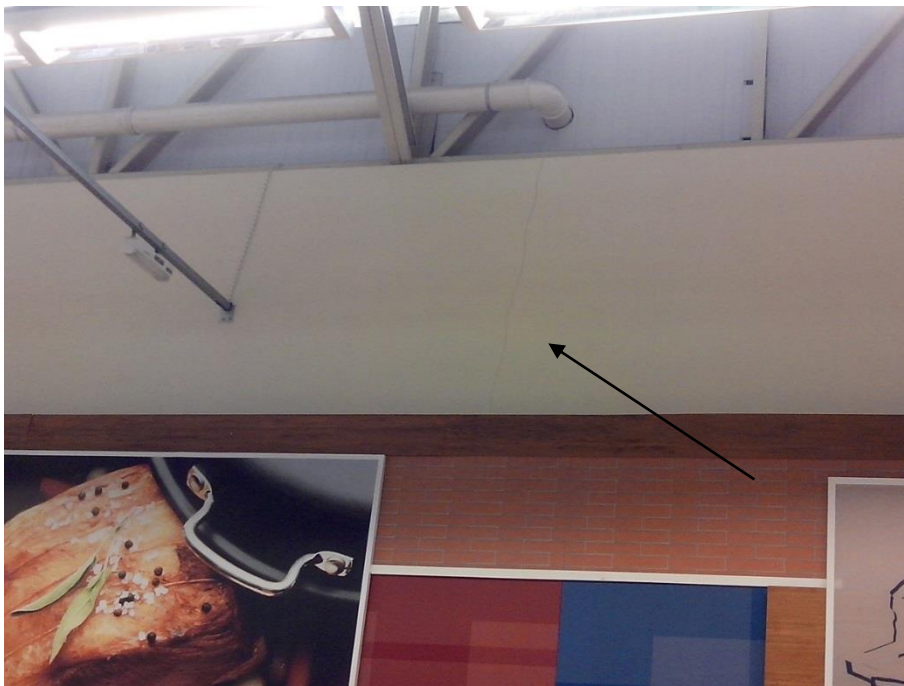
Figura 3.35 - Rachadura na parede interna da loja (lado 3).
