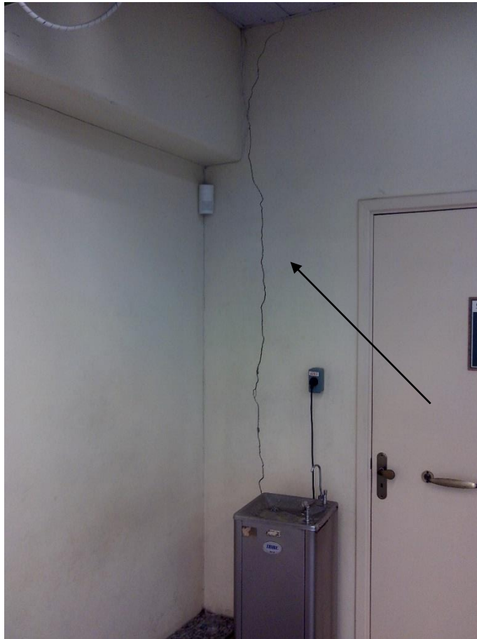
Figura 3.32- Rachadura na parede interna da loja (lado 4).
