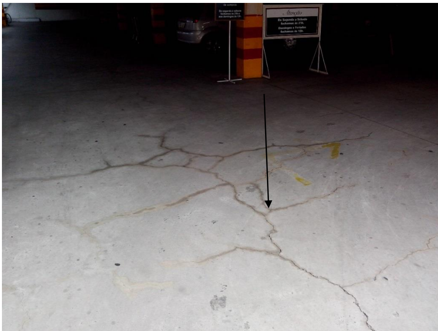
Figura 3.27 - Rachadura no chão do estacionamento.
