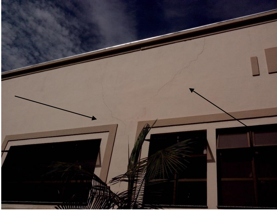
Figura 3.38 - Rachadura na fachada (lado 1).
