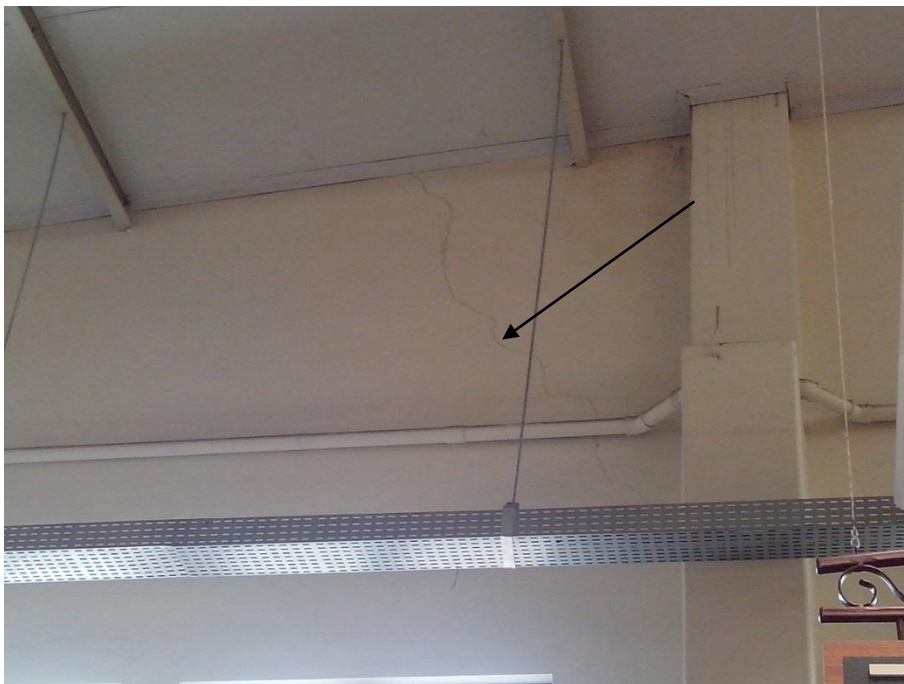
Figura 3.33- Rachadura na parede interna da loja (lado 4).
