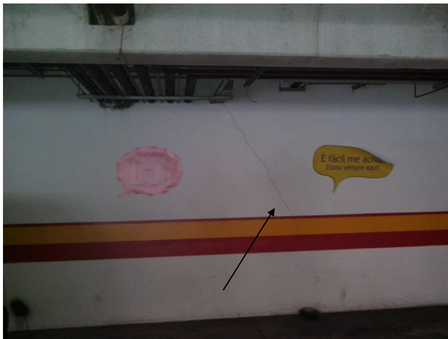
Figura 3.28 - Rachadura na parede interna do estacionamento (lado 3).
