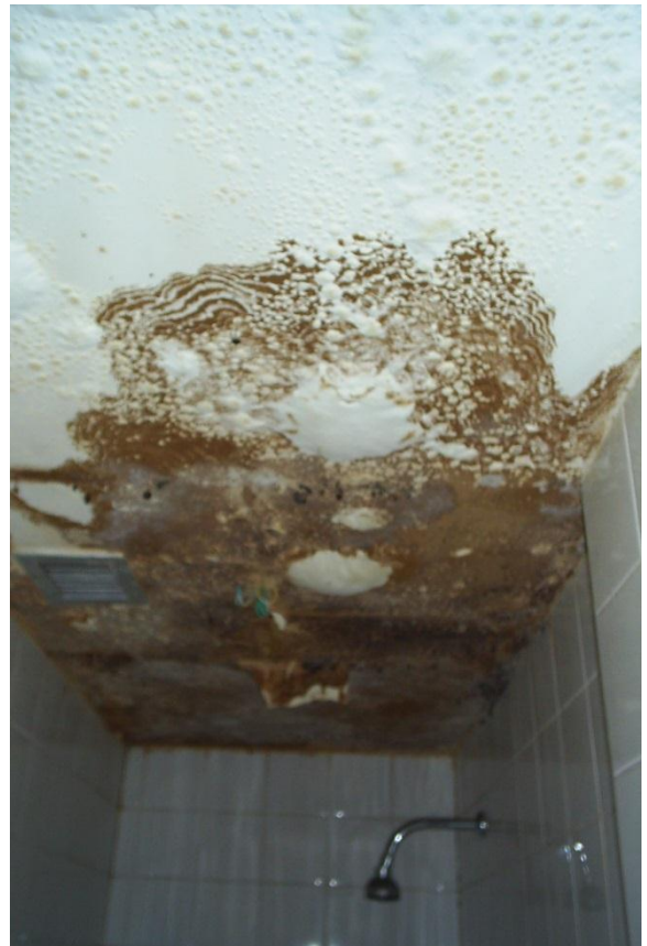
Figura 23 - Teto da unidade inferior infiltrado
