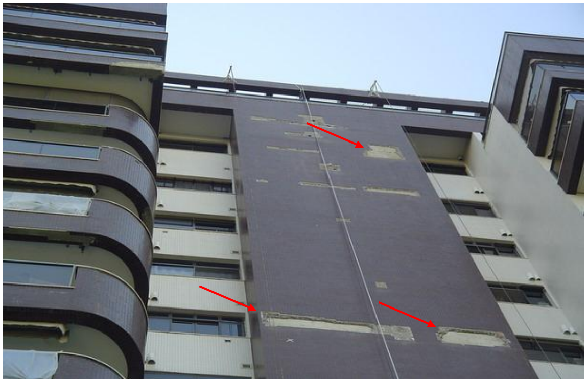
Figura 26 - Áreas identificadas com som cavo
