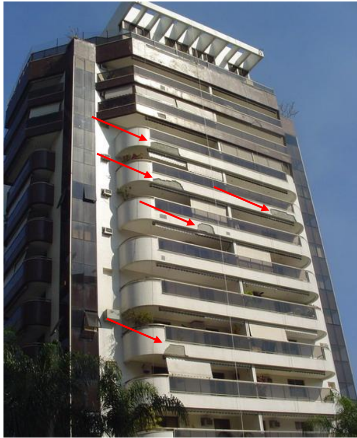
Figura 25 - Áreas identificadas com som cavo
