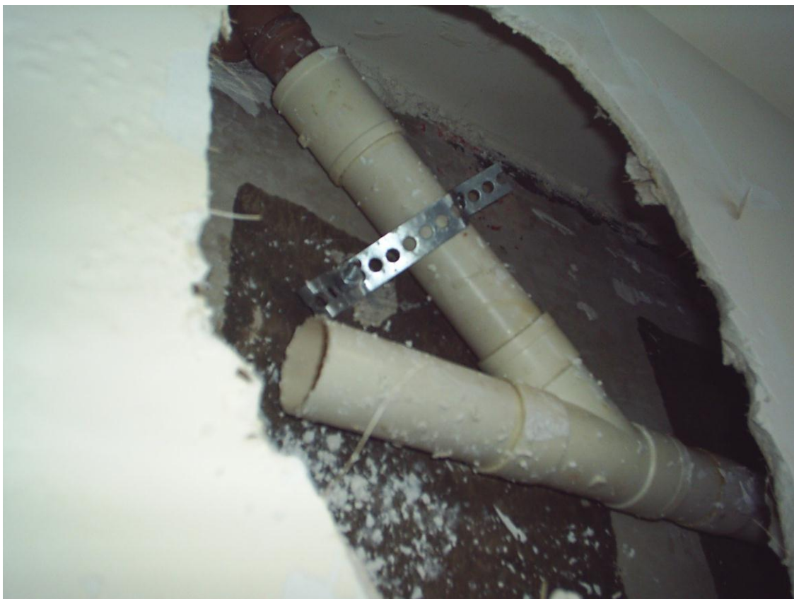
Figura 19 - Tubulação de esgoto do ramal secundário incompleta
