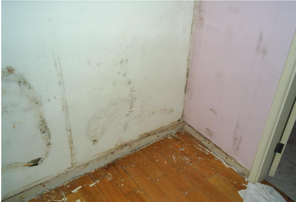
Figura 4 - Paredes infiltradas pela falha na impermeabilização do banheiro
