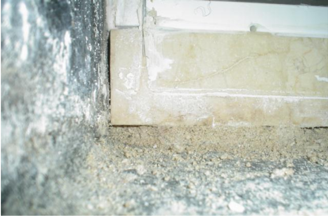
Figura 8 - Detalhe da falta de impermeabilização entre a parede e o tecto
