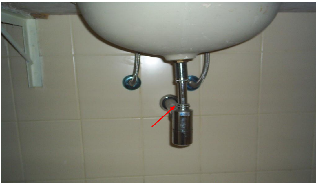
Figura 21 - Má instalação do sifão da pia
