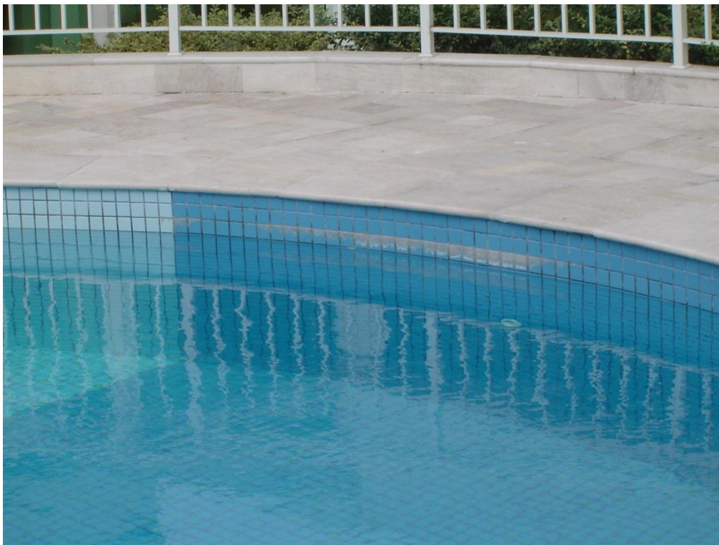
Figura 10 - Sinais de infiltração em toda a borda da piscina
