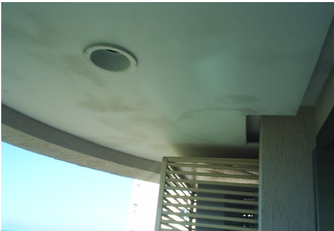
Figura 30 - Teto de varanda apresentando manchas de mofo e bolor
