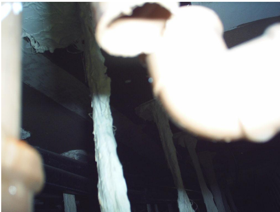
Figura 15 - Tubo desconectado pela pressurização do sistema
