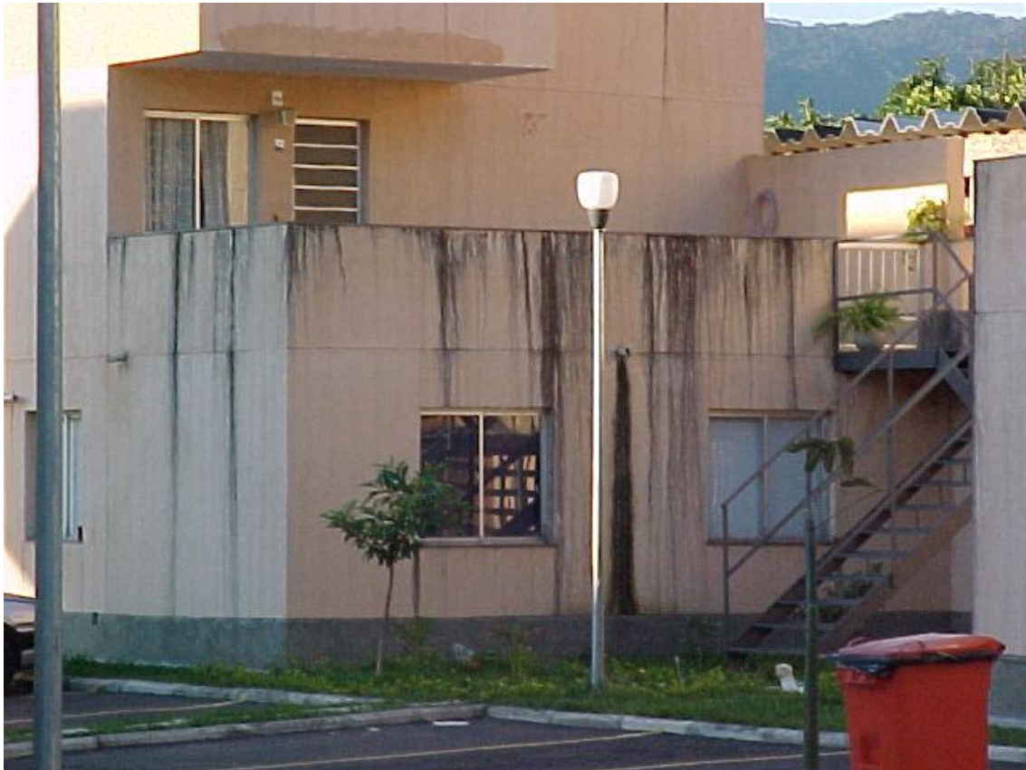
Figura 28 - Fachada de casa machada por falta de pingadeira no chapim da platimbanda
