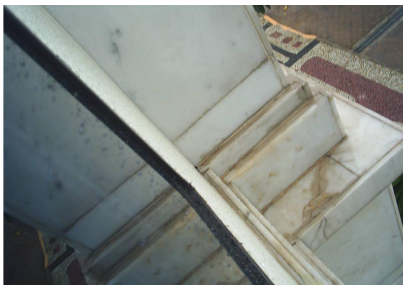
Figura 33 - Castelo da fachada com rejuntamento falho
