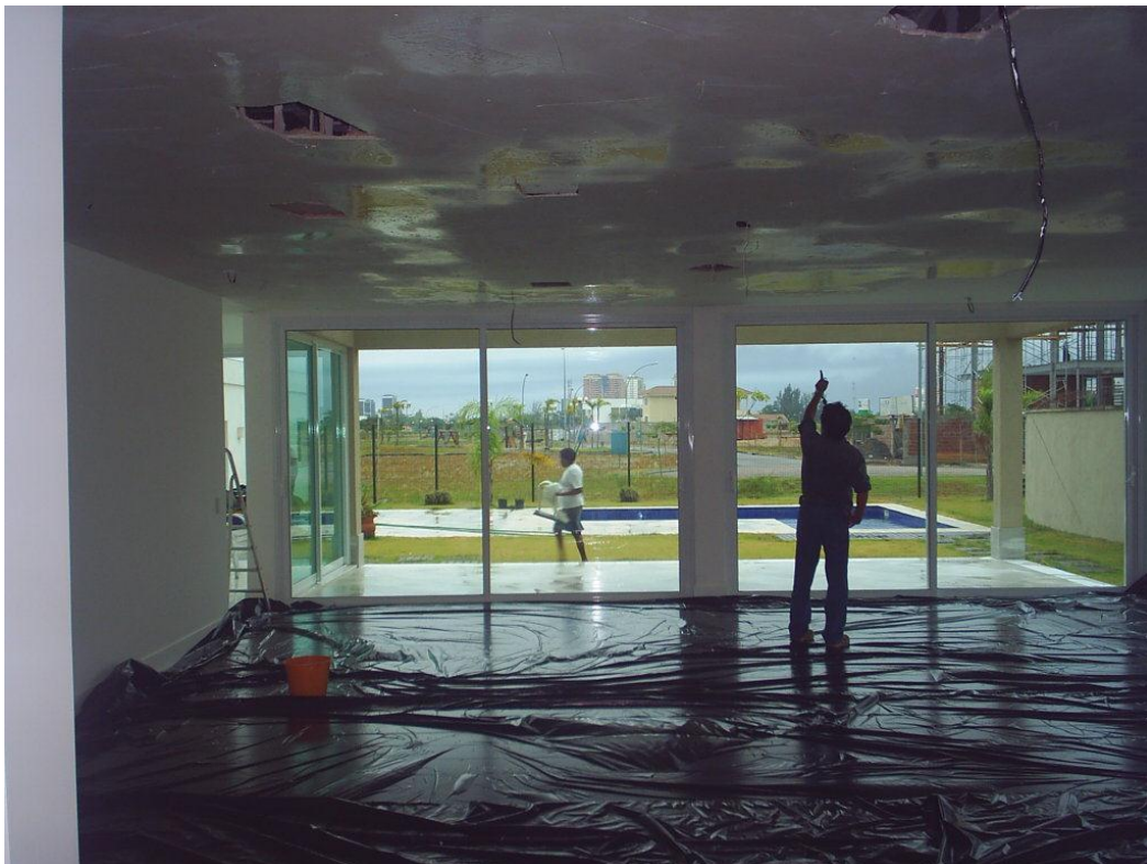
Figura 17 - Teto da sala completamente danificado
