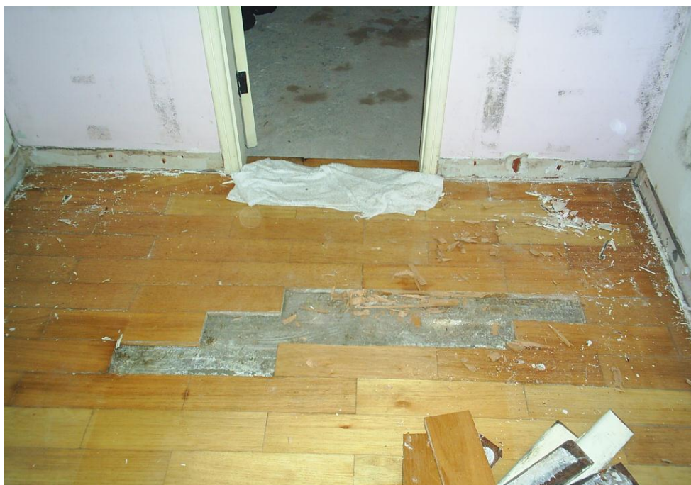
Figura 5 - Revestimento de taco levantou devido a presença de água no piso do quarto adjacente
