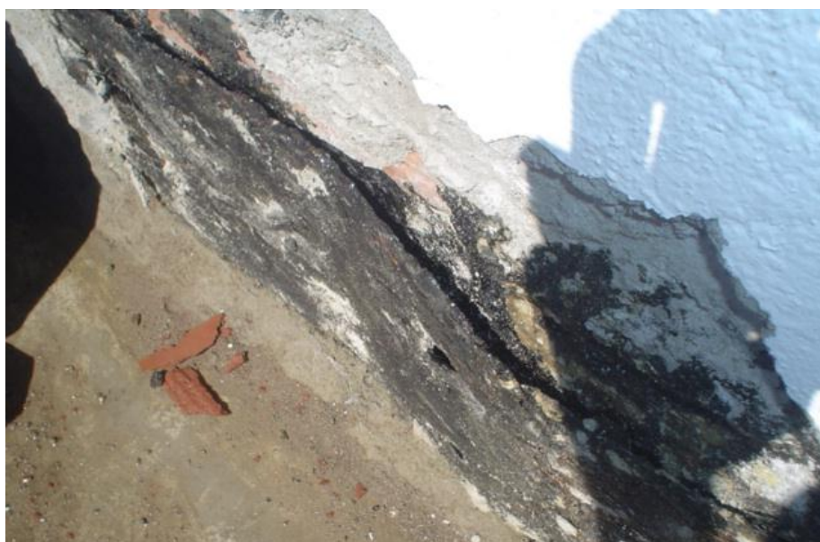
Figura 14 - Detalhe da manta reto na alvenaria, permitindo a percolação d'água e descolagem
