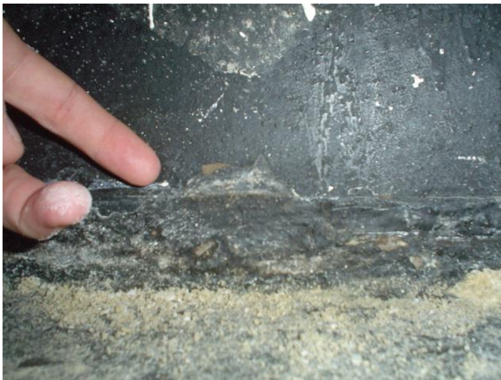
Figura 6 - Impermeabilização rígida trincada no final da placa de dry-wall
