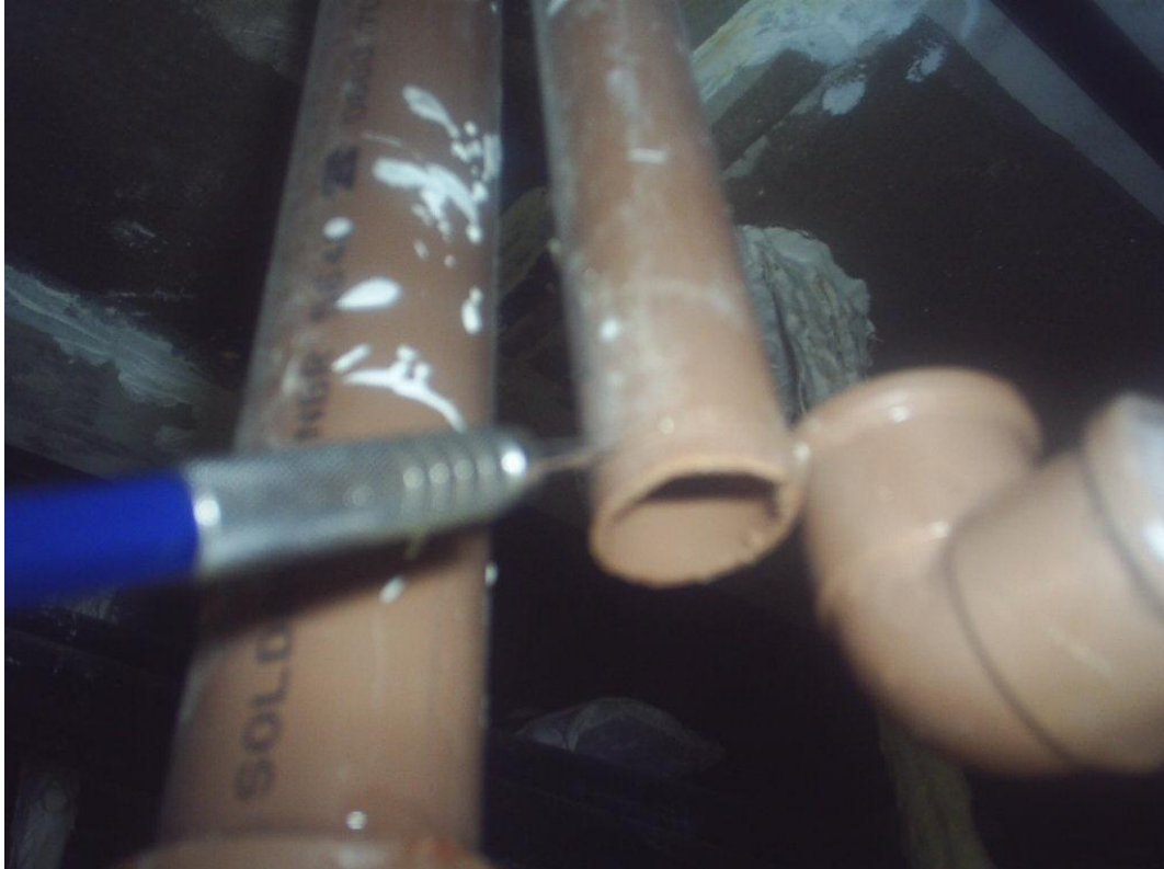
Figura 16 - Área colada insuficiente, inferior a 4mm
