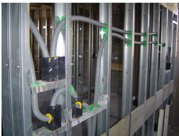
Figura 7 - Tubulação Elétrica na Estrutura de Drywall FONTE: Lessa (2005)
