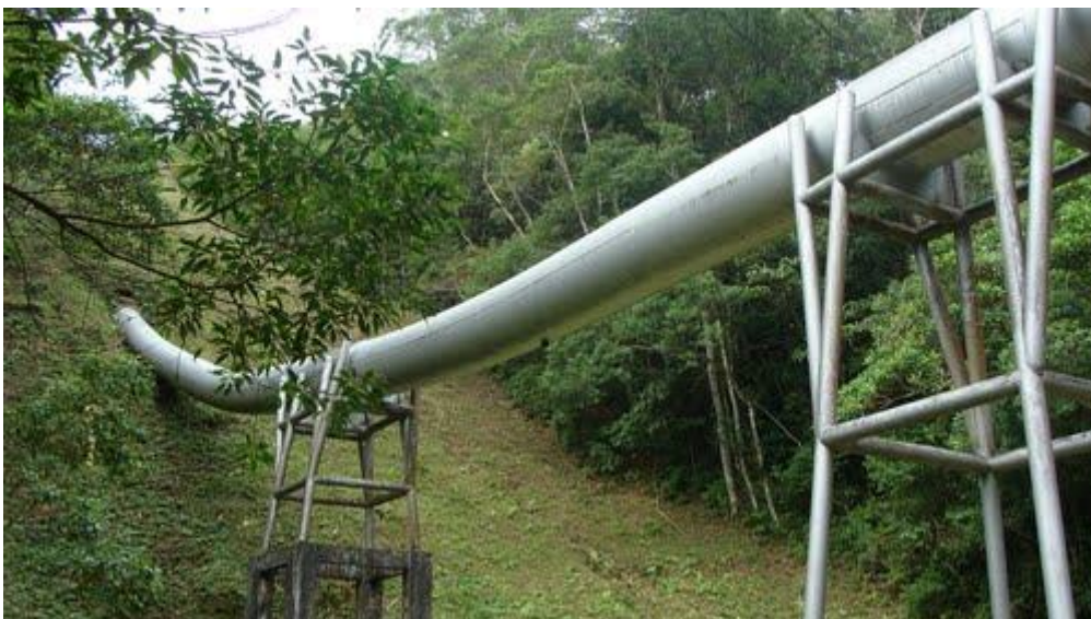
Figura 2 – Passagem aérea do oleoduto OSVAT no estado de São Paulo. Foto obtida em: http://www.panoramio.com/photo/35889330
