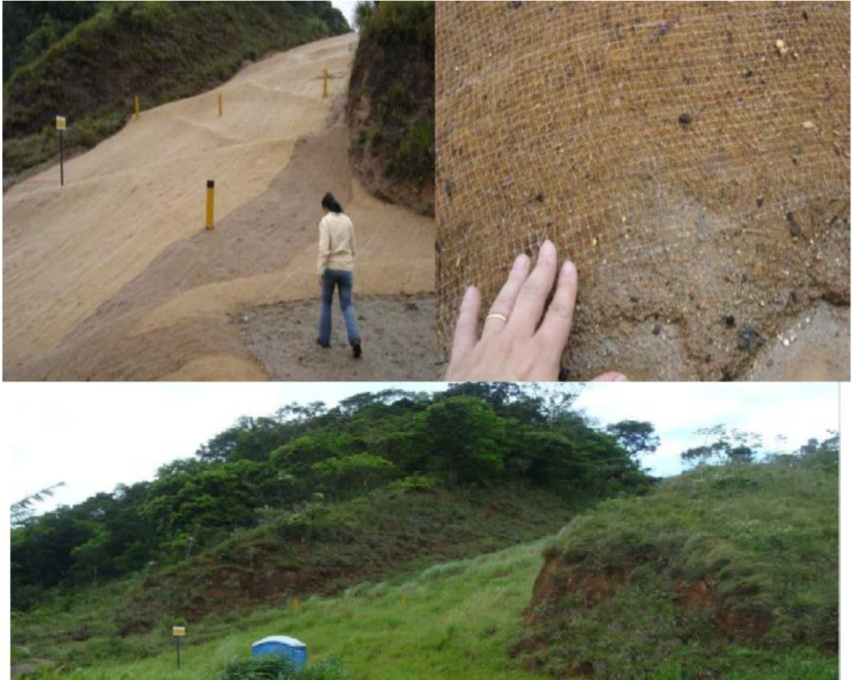
Figura 16: Troca da cobertura vegetal existente na faixa, com crescimento controlado para evitar erosão e garantir a integridade do duto. Fonte: IBP.
