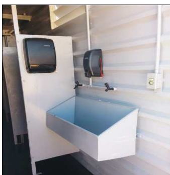
Figura 5 - Container vestiário ( http://www.visautolocacoes.com.br/ , 2012)
