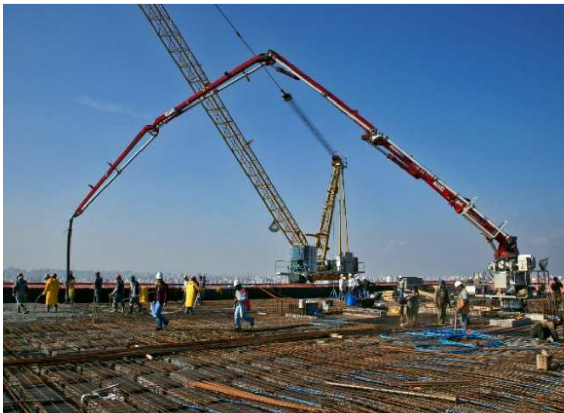
Figura 113 - Concretagem executada com mastro de distribuição de concreto tipo placing boom ( http://kaioba.com.br/ , 2013)
