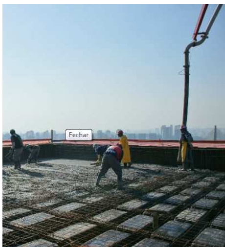
Figura 106 - Não existe tubulação apoiada na laje e apenas um funcionário segura o mangote ( http://kaioba.com.br/ , 2013)
