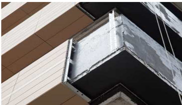
Figura 204 - Fachada com revestimento não aderido ( http://www.engenhariae arquitetura.com.br/ , 2013)
