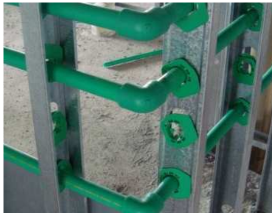
Figura 123 - Instalação hidráulica embutida na parede ( http://www.engenhariaearquitectura.com.br/ , 2013)
