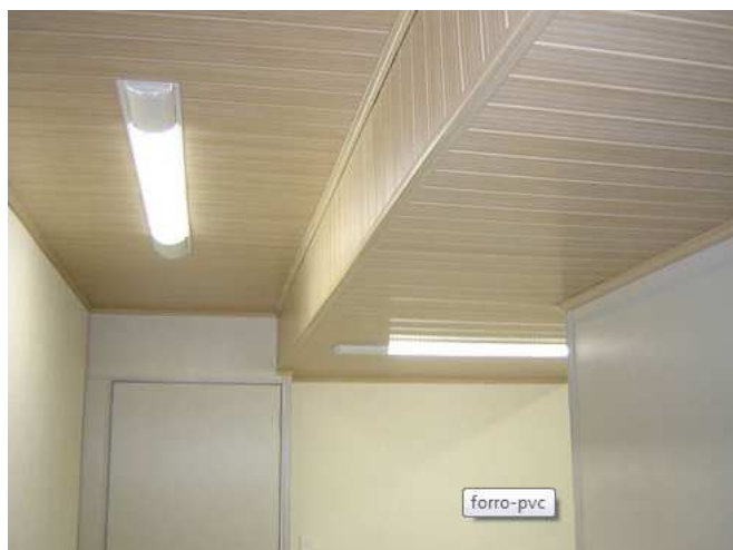
Figura 183 - Utilização de forro PVC ( http://construindo.org/ , 2013)
