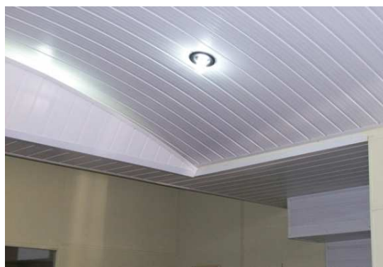
Figura 172 - Utilização de forro PVC ( http://construindo.org/ , 2013)
