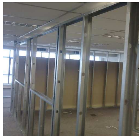
Figura 117 - Estrutura Drywall ( http://www.facilityservicos.com.br/ , 2013)
