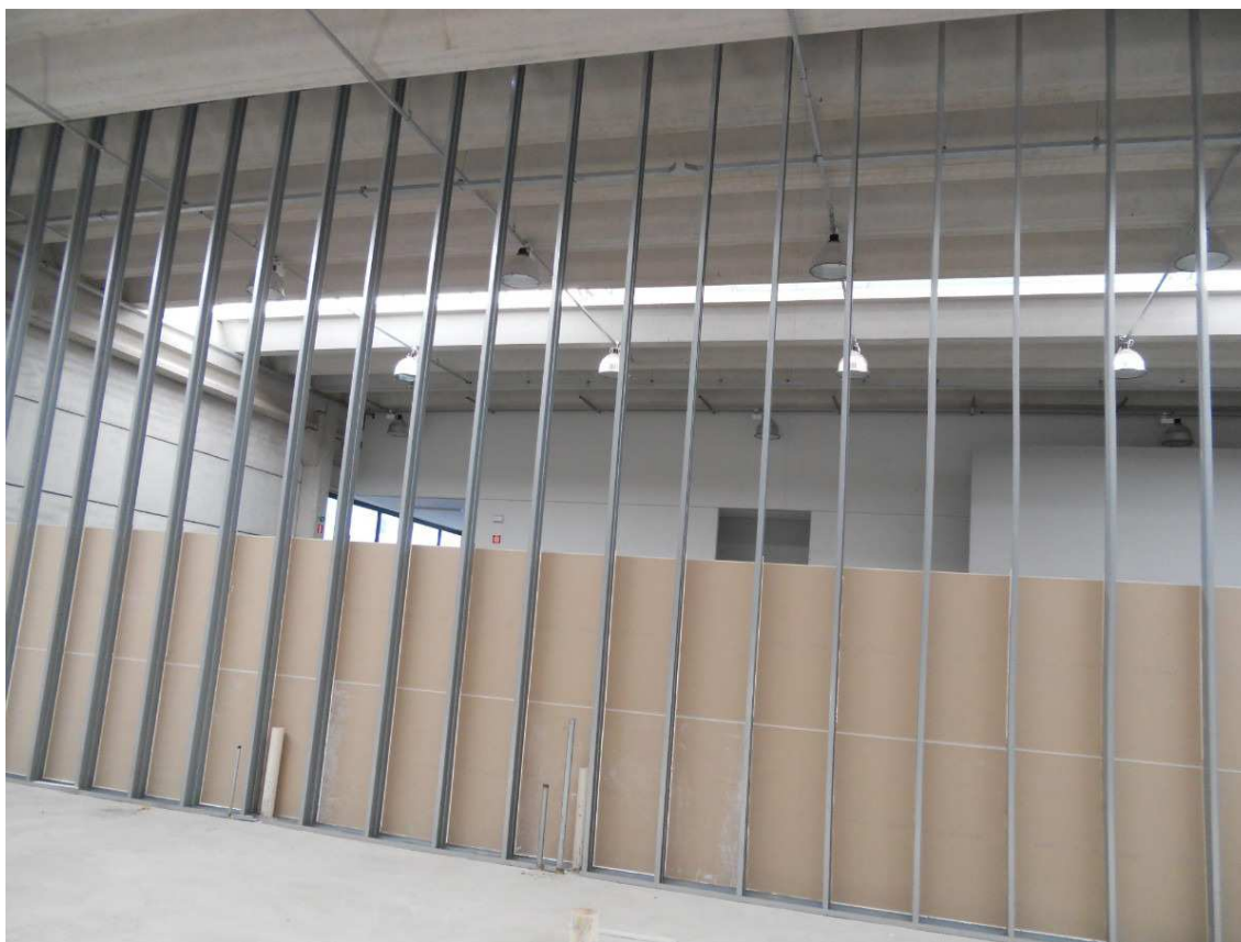
Figura 118 - Estrutura Drywall ( http://www.facilityservicos.com.br/ , 2013)
