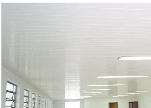
Figura 171 - Utilização de forro PVC ( http://soforropvc.com/ , 2013)
