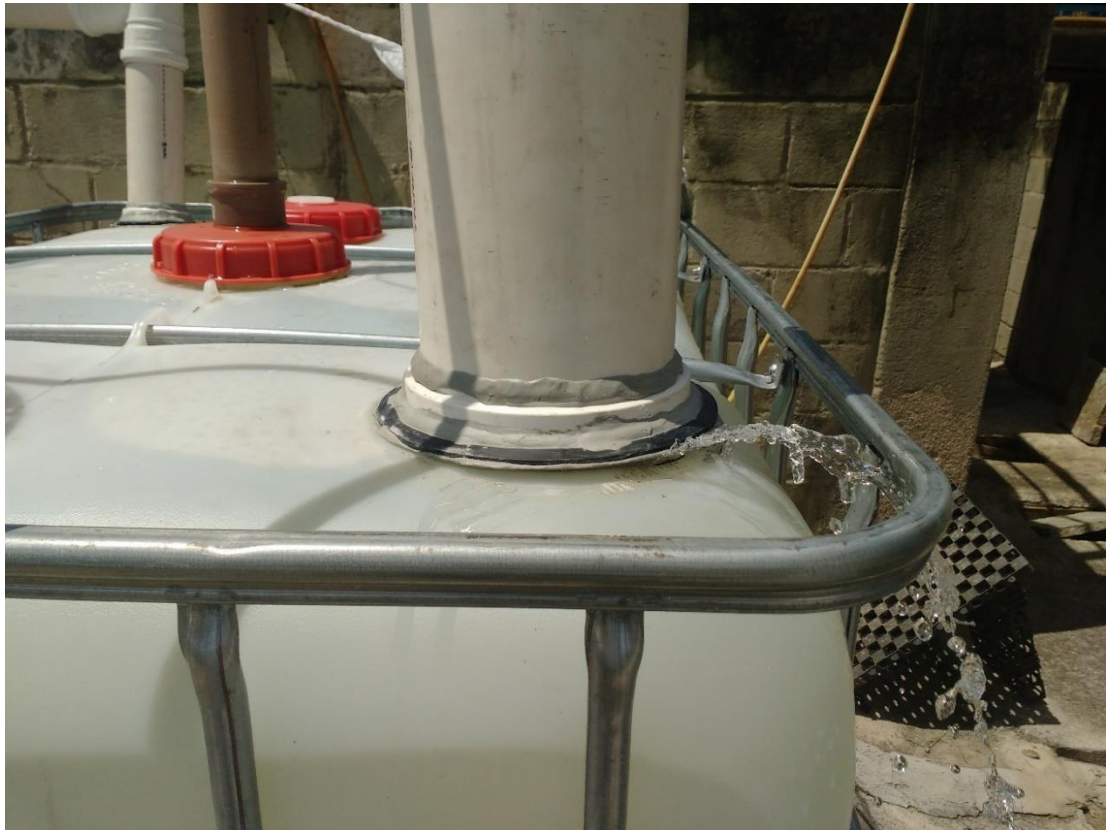
Figura 43: Vazamento severo no tubo de alimentação de 150mm (Fonte: Acervo do Autor)
