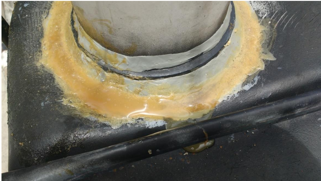
Figura 46: Primeiro teste de estanqueidade bem sucedido após o reparo (Fonte: Acervo do Autor)
