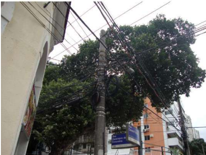
Figura 70: Painel de fotos dos fios elétricos de Botafogo
