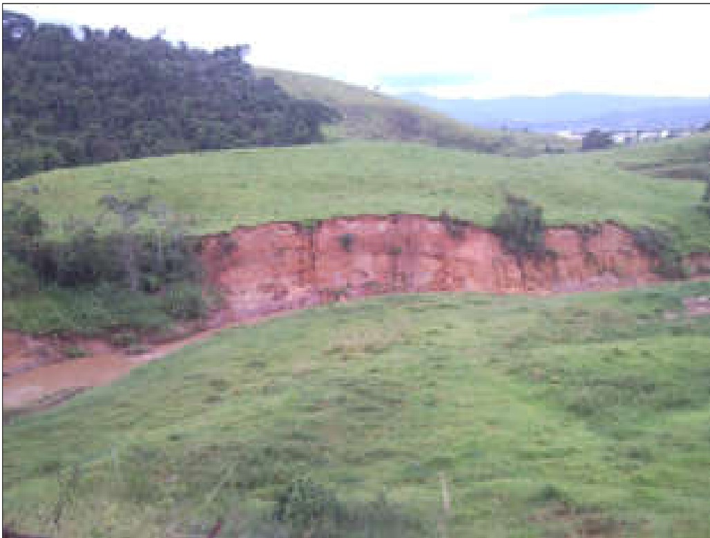
Figura 5-24: Erosão na área rural. Foto do autor 2010.
