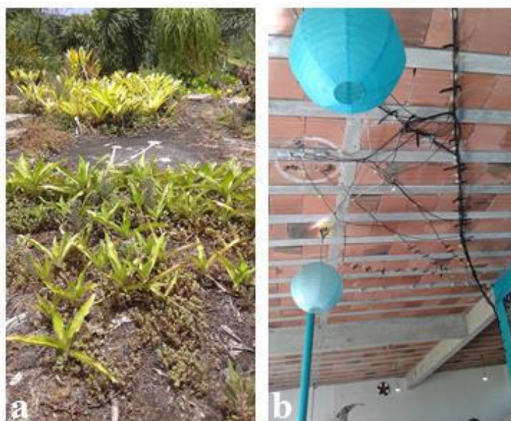
Figura 3.9 - Sensores térmicos da superfície do telhado. a) Superfície externa, b) Superfície interna.
