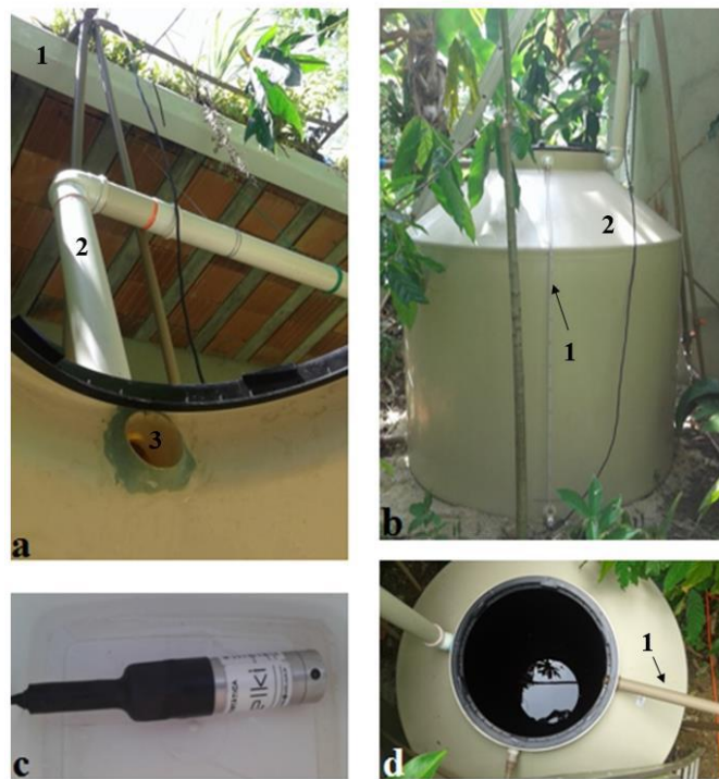
Figura 3.11 - Componentes do sistema de coleta de água de chuva. Sendo a.1) Calha de PVC; a.2) Condutores de PVC; a.3) Entrada ao reservatório, b.1) Coluna com medição a cada 1cm; b.2) Caixa d'água com capacidade de 2500L, c) Sonda de Nível Tipo Hidrostático VKL-214 e d.1) Conductor de saída do reservatório.
