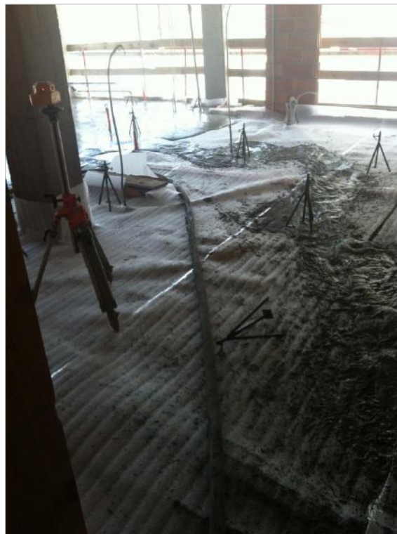
Figura 67: Vertido de la capa de mortero de cemento Fuente: AMSA Arquitectura. Barcelona, España.
