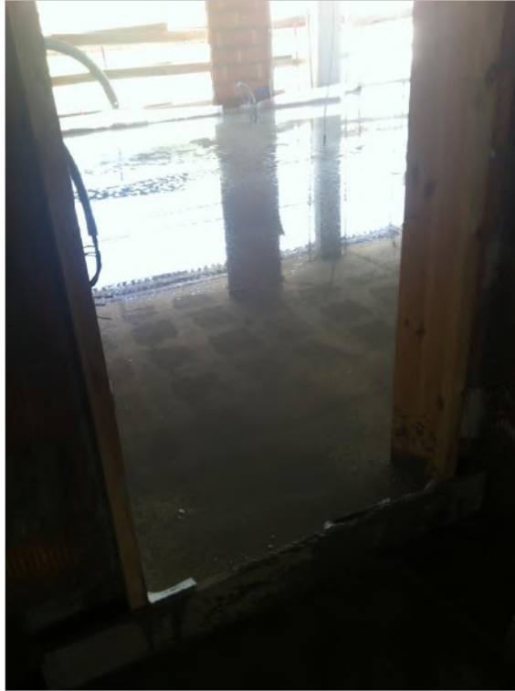
Figura 73: Fraguado de la capa de mortero de cemento Fuente: AMSA Arquitectura. Barcelona, España.
