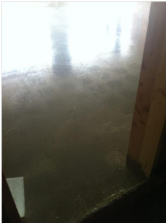
Figura 74: Fraguado de la capa de mortero de cemento Fuente: AMSA Arquitectura. Barcelona, España.
