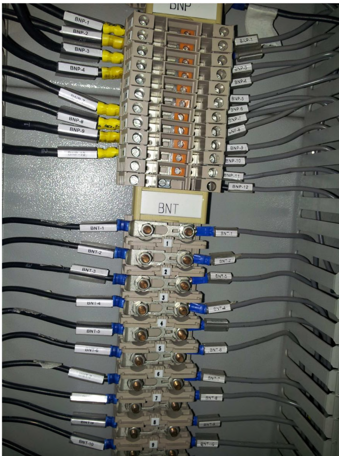
Figura 28 - Cabos de interligação ligados nos bornes
