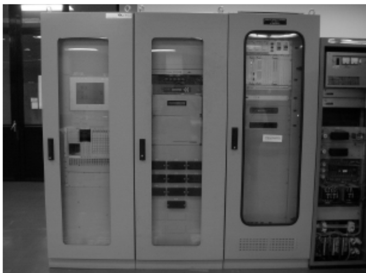
Figura 18 - Painéis de Controle e Proteção.
