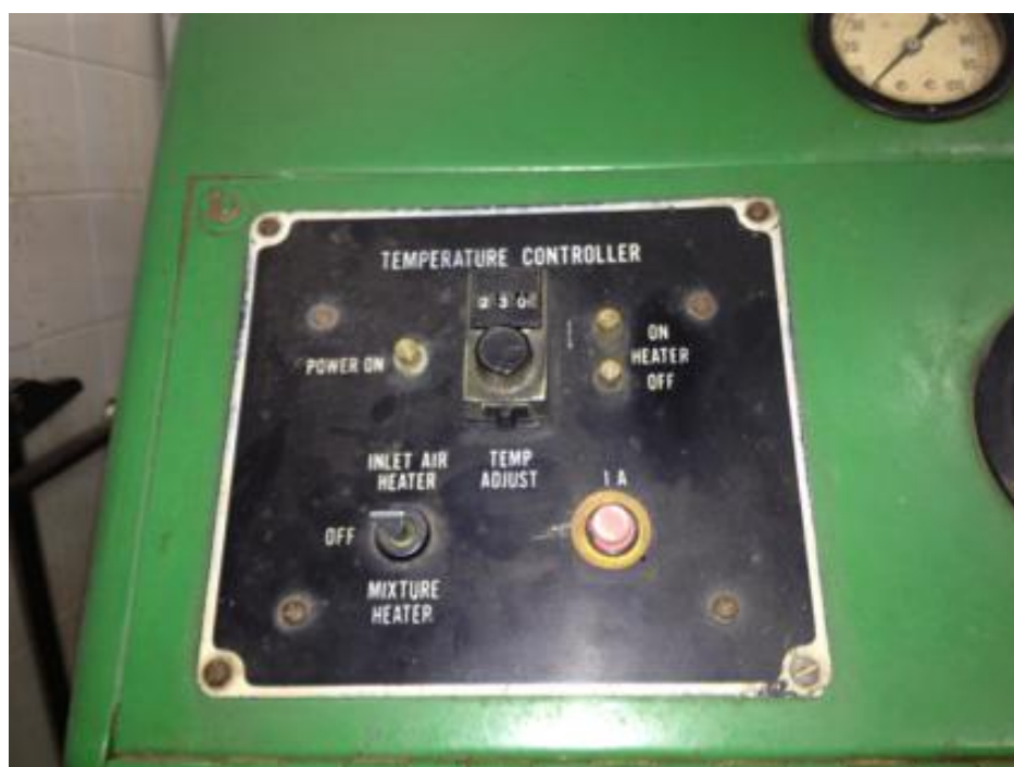
Figura 3.2 - Controlador de temperatura Waukesha
