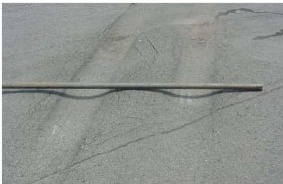
Figura 2.10: Exemplo de deformação permanente em pavimento asfáltico (FRANCO, 2007).
