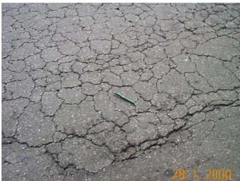
Figura 2.9: Exemplo de trincamento tipo couro de jacaré, fadiga de revestimentos asfálticos (MOTTA, 2003).
