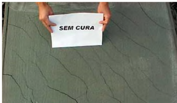
Figura 8 - Fissuras devido à falha de cura (www.basf-cc.com.br, 2014)
