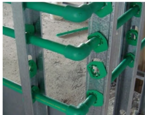
Figura 21 - Instalações Hidráulicas ( www.facilitieservicos.com.br , 2013)
