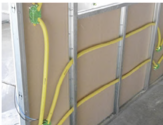
Figura 20 - Instalações elétricas ( www.facilitieservicos.com.br , 2013)
