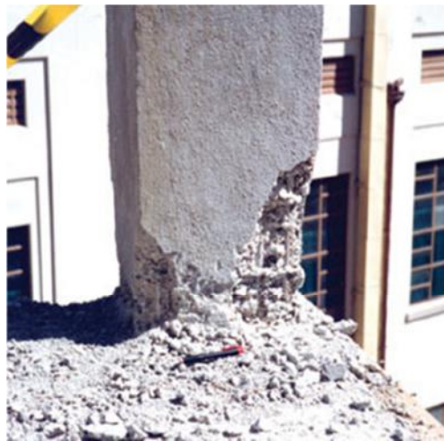
Figura 7 - Bicheira - falha de concretagem que deixa exposta a armadura e os componentes do concreto ( http://equipedeobra.pini.com.br , 2009)
