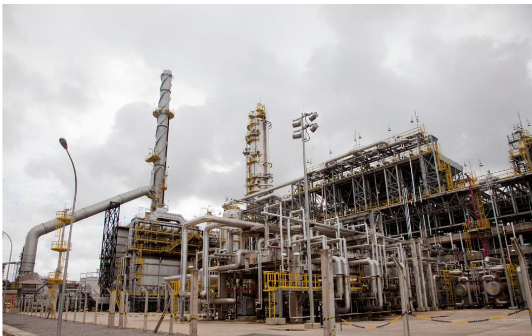
Figura 1.1 – Unidade de Destilação Atmosférica do Trem 1 da Refinaria Abreu e Lima. Fonte: Petrobras, 2017
