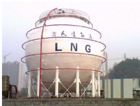
Figura 17 – Tanque pressurizado esférico
