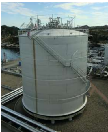
Figura 18 - Tanque com capacidade de armazenamento de 2.000m 3
