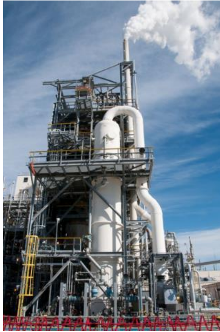
Figura 9 – Lavador de Gases (NRS) instalado na planta de LaPorte em 2011 para redução das emissões. Fonte: CSB, 2015
