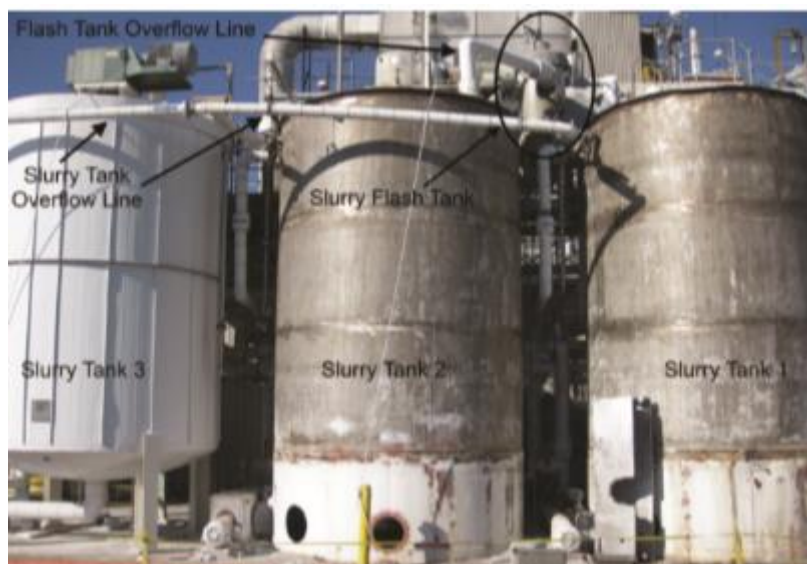
Figura 5 – Reservatórios de produto PVF (“ slurry tanks ”) após a reação de conversão. Fonte: CSB, 2012
