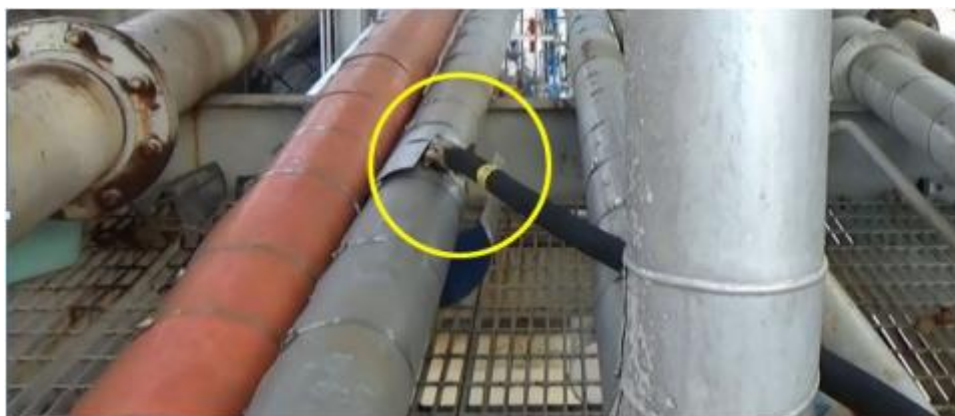
Figura 13 – Mangueira de água quente na linha de alimentação de metil mercaptano ao sistema de reação como estratégia de dissociar o hidrato formado. Fonte: CSB, 2015.
