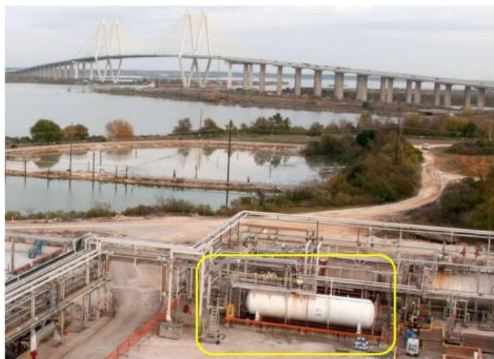
Figura 7 – Tanque de armazenamento de metil mercaptano na fábrica de LaPorte, Texas destacado em amarelo. Fonte: CSB, 2015
