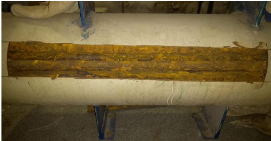
Figura 29. Foto do trocador fora de uso com o casco aberto (foto própria)
