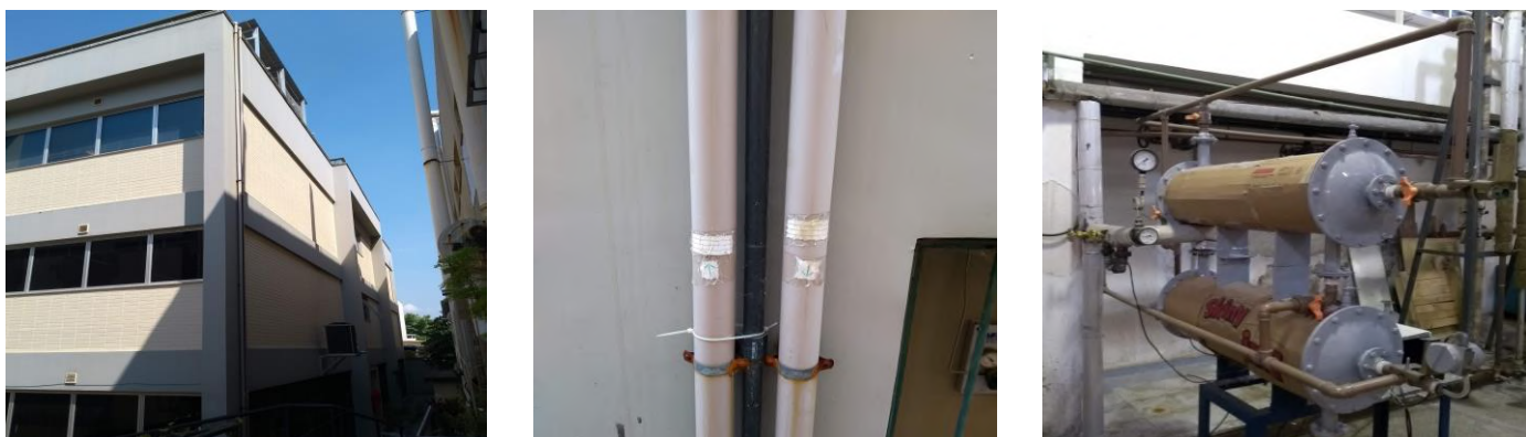
Figura 34. Partes do circuito atual do sistema de refrigeração, constituído de PVC (fotos próprias)
