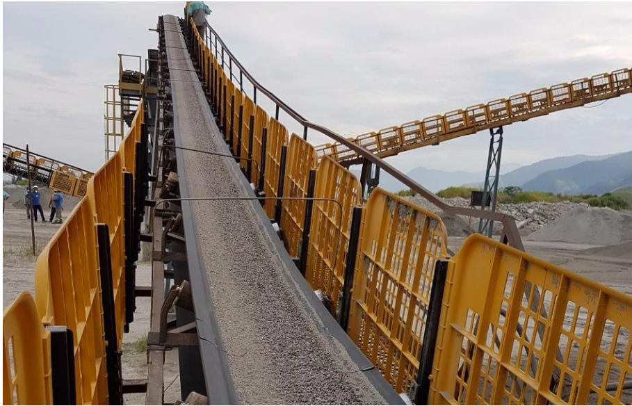
Figura 4.3- Correia TC-16 da usina de agregados Santa Luzia
