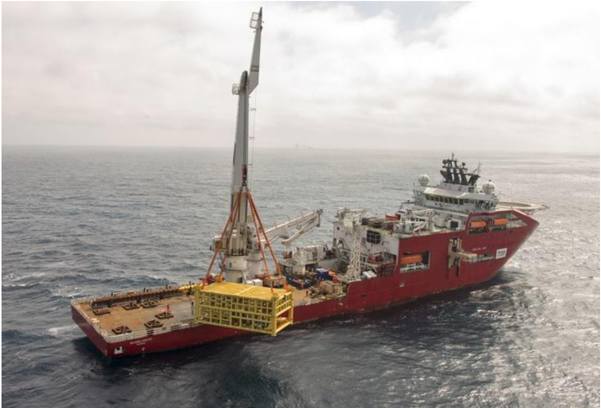
Figura 2.2: Fase aérea da instalação de equipamentos (fonte: Biblioteca de imagens da Ithaca Energy).
