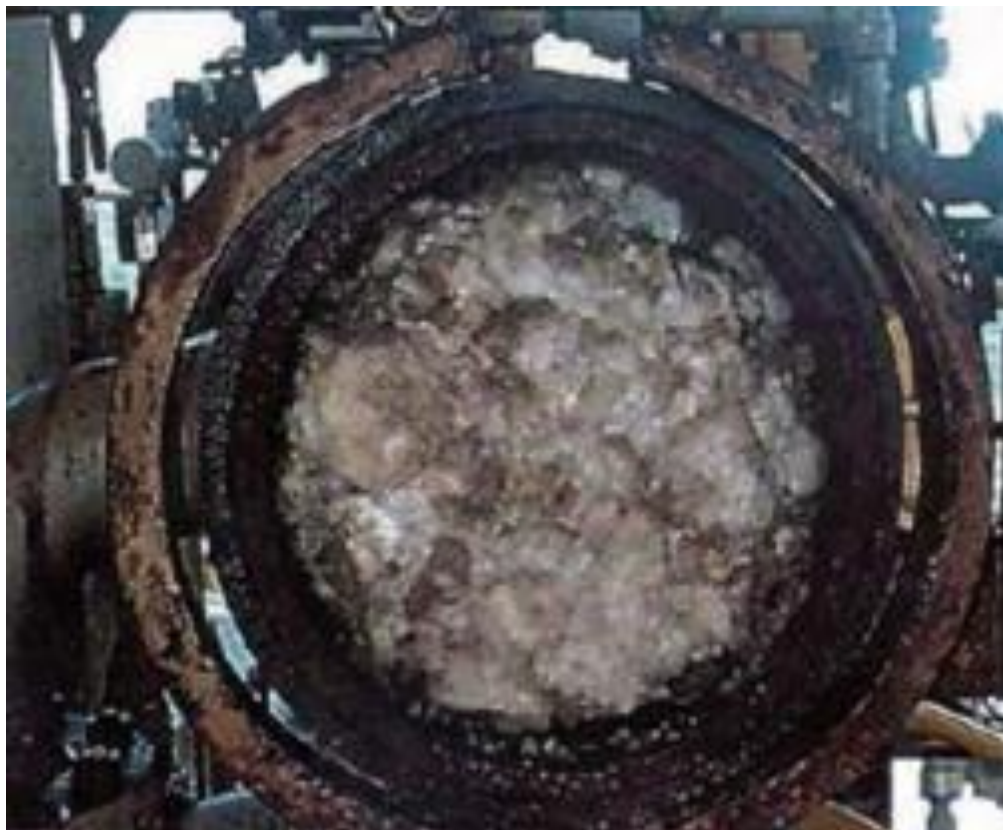
Figura 2.7: Obstrução por hidrato.
