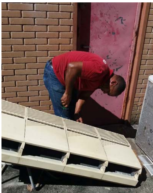
Foto 8 - Postura forçada do técnico durante intervenção em aparelho de ar condicionado
