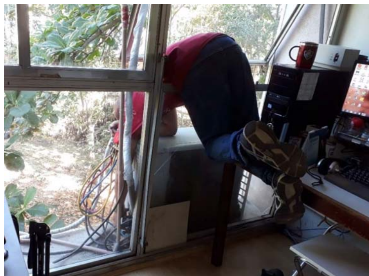
Foto 5 – Técnico executando manutenção no ar condicionado de um laboratório localizado no segundo andar do edifício
