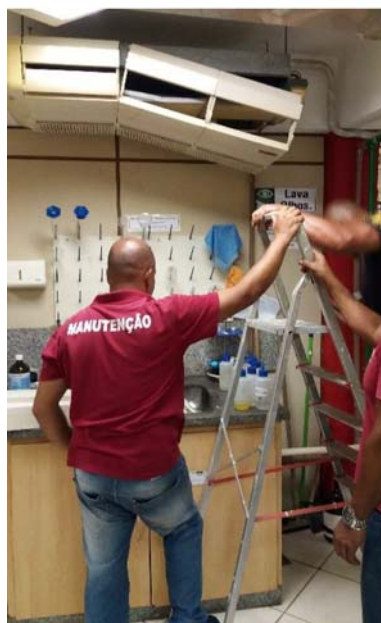
Foto 7 - Dificuldade de acesso ao aparelho de ar condicionado
