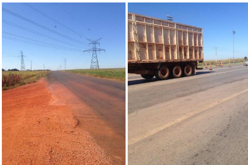
Figura 50 – Afundamentos de trilha de rodas pouco ou nada evidentes nas rodovias: Rodovia MT 249 em Nova Mutum (foto da esquerda) e BR 163 na praça de pedágio entre as cidades de Sorriso e Sinop.
