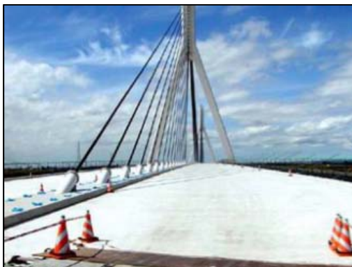
Figura 2.8: Tabuleiro de ponte estaiada em Hokkaido (Japão) utilizando o SHCC em sua construção (ECC APPLICATIONS, 2017).
