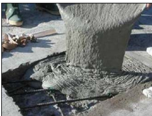
Figura 2.9: Aplicação de SHCC no reparo do tabuleiro de uma ponte em Michigan/Estados Unidos (LEPECH e LI, 2009).
