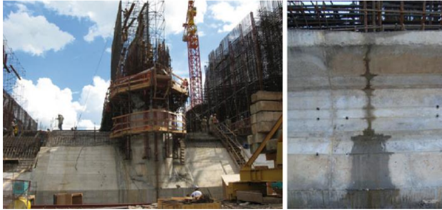
Figura 1.5: Vertedouro de pequenas centrais hidrelétricas e fissuras térmicas (FUNAHASHI e KUPERMAN, 2010)
