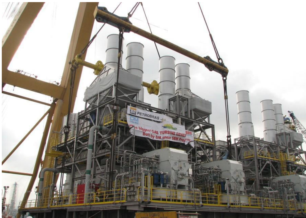
Figura 14 - Módulo de Geração de Energia da P-57 (Dyna Mac, 2020)
