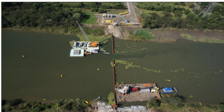
Figura 33: Vista aérea da soleira submersa no Canal de São Francisco. (ANA, 2016b)
