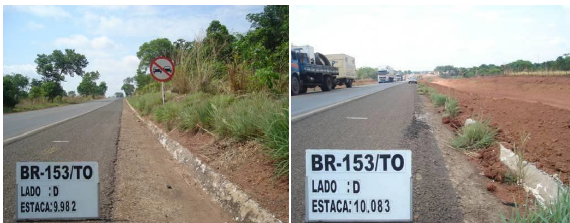
Figura 5.1 – Exemplos de sarjetas que deverão ser limpas ou receber algum reparo no BR 153 (DNIT, 2012)
