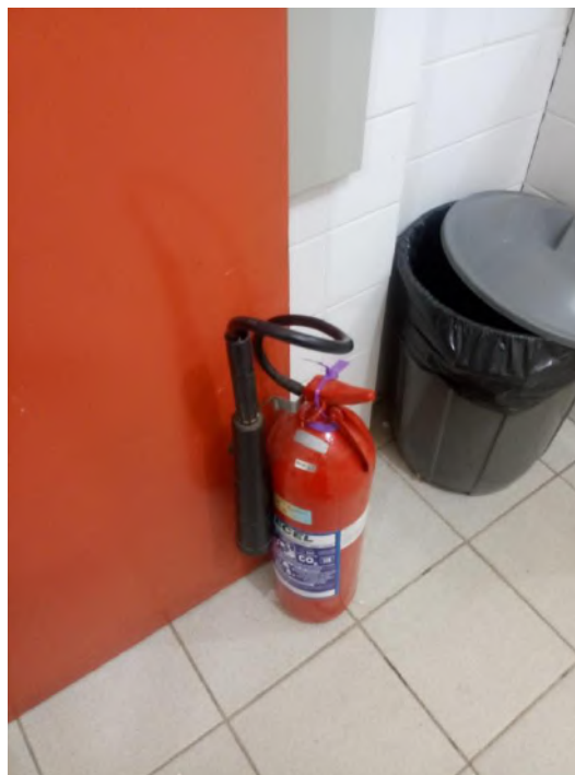
Figura 10. Extintor de incêndio CO 2 Fonte: Autor
