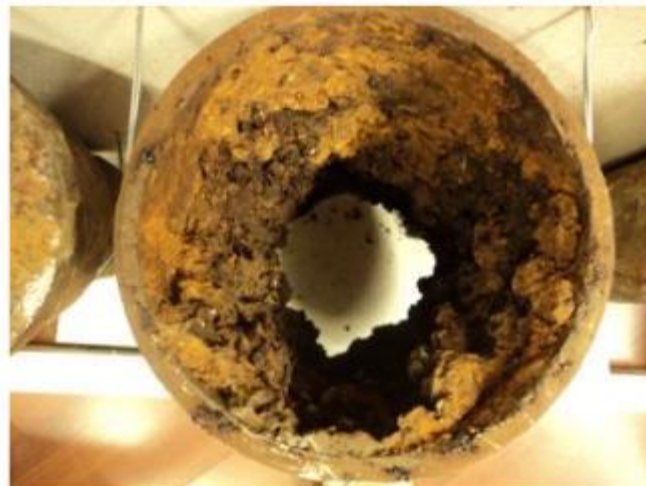
FIGURA 14 – Tubulação danificada. Fonte: Pausa para refletir, 2017.
