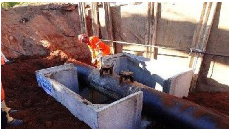
Figura 3.4 – Inspeção de um trecho do mineroduto onde ocorreu erosão do terreno. [24]
