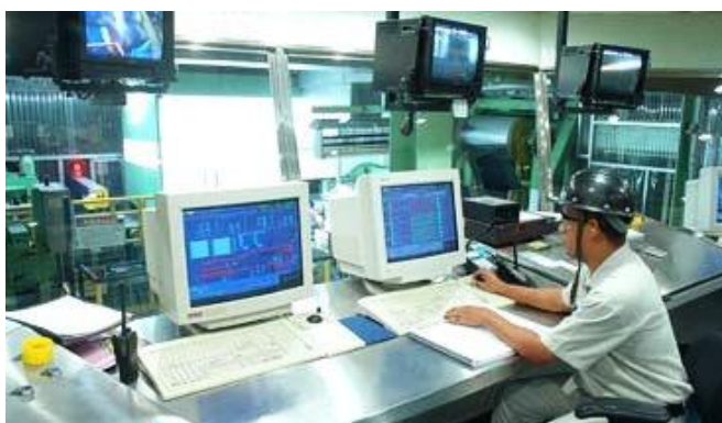
Figura 3.2 – Sala de controle de operação do mineroduto. [22]
