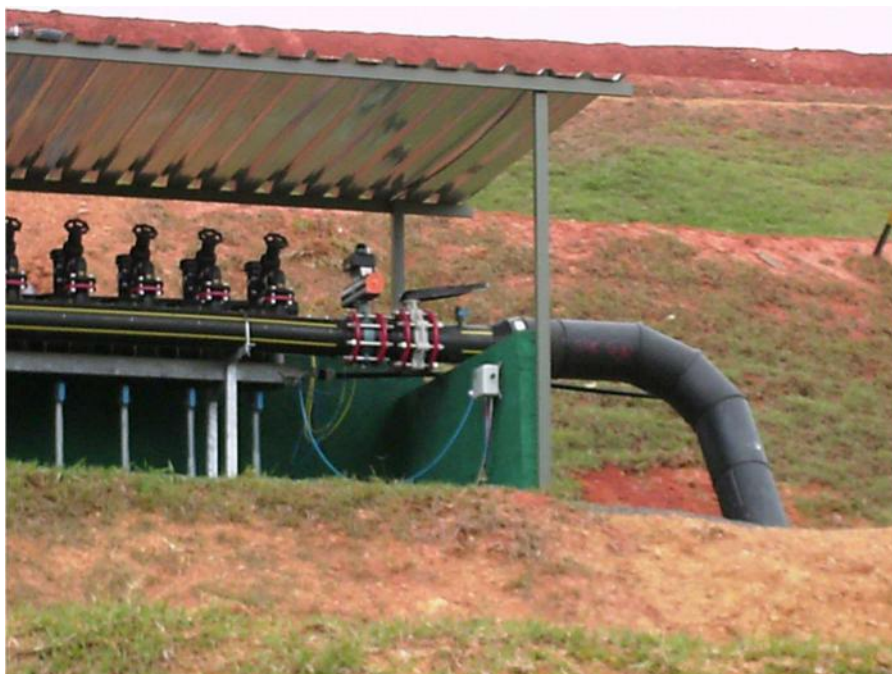
Figura 2 - Tubos de coleta de gás
