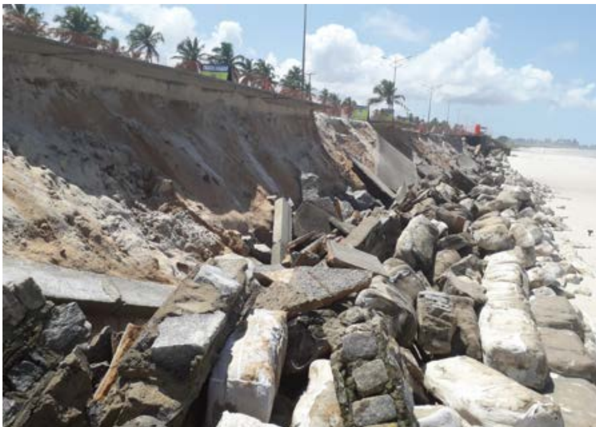
Figura 2 – Destruição de estrutura de proteção costeira do tipo BagWall e calçadão pela ação de processos erosivos marinhos ocorridos na Praia da Avenida, situada no bairro do Pontal da Barra (Litoral Sul de Maceió, Alagoas). Elaborado pelos autores.
