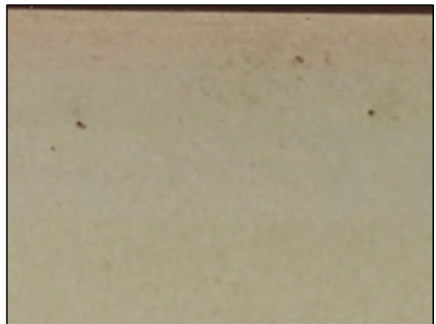
Figura 33: A obra; sujidades, pontos escuros isolados (lado esquerdo). Fonte: ALVES (2021)
