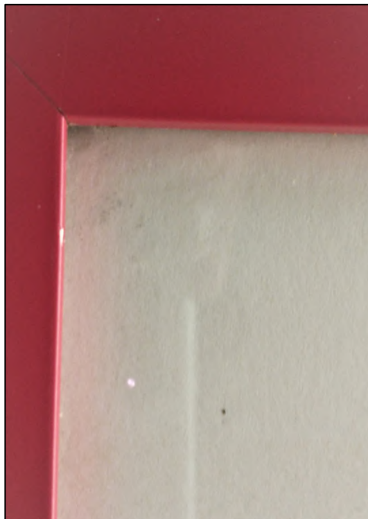
Figura 24: A obra; sujidades, abaulamento (canto superior direito). Fonte: ALVES (2021)
