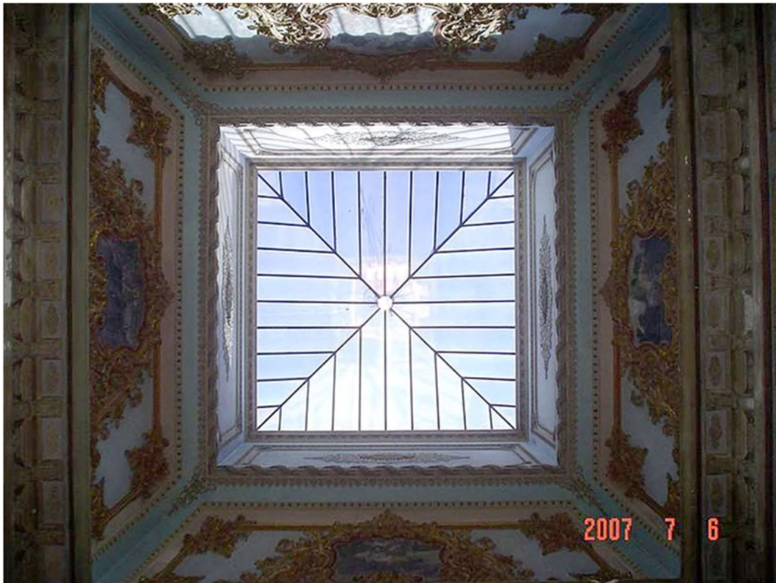
Figura 7 Fotografia da vista interna da clarabóia acima da escadaria principal. Astorga Arquitetura. Disponível em https://www.astorgaarquitetura.com/solar-da-marquesa-de-santos
