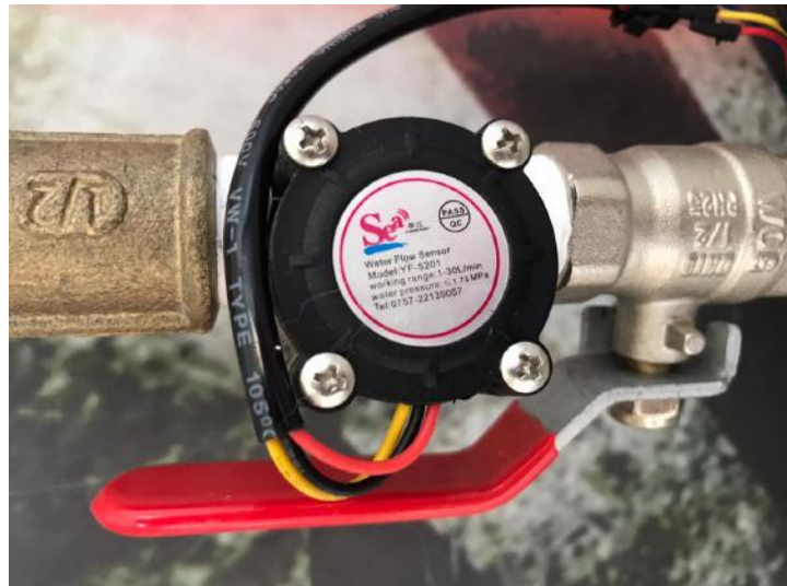
Figura 3.12 – Posicionamento do sensor de vazão
