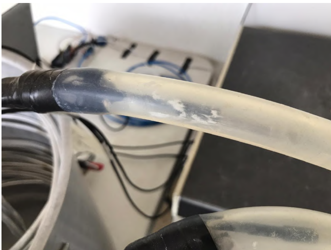
Figura 3.8 – Entrada das serpentinas com sensor de temperatura no interior
