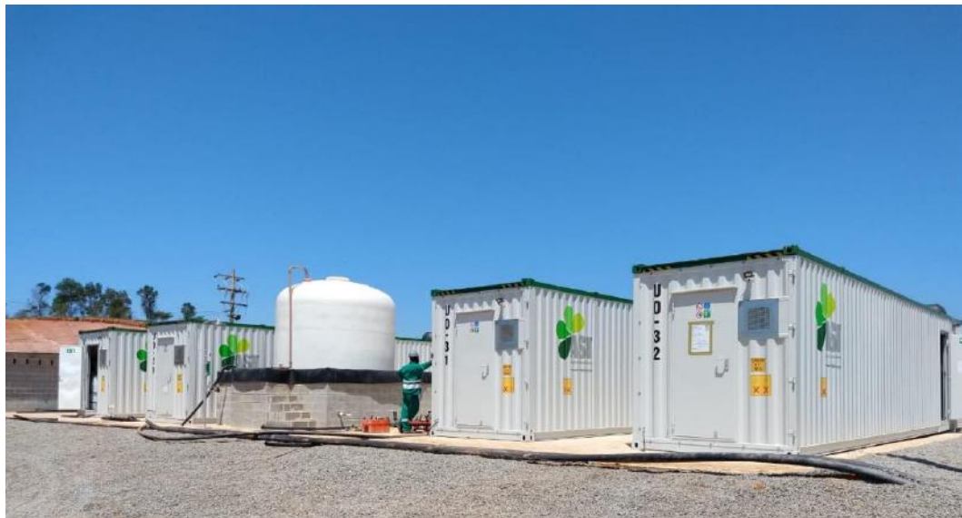
Figura 6 - Planta de tratamento com tecnologia de Osmose Inversa no aterro de Seropédica.
