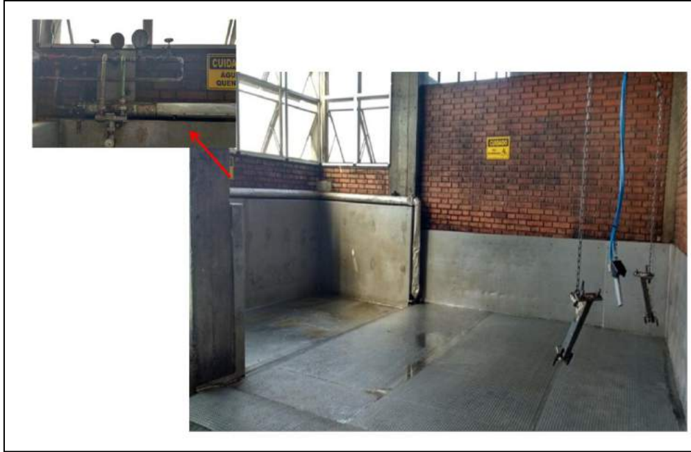
Figura 5.6: Área de lavagem das masseiras e detalhe para o hidrômetro instalado (Fonte própria)
