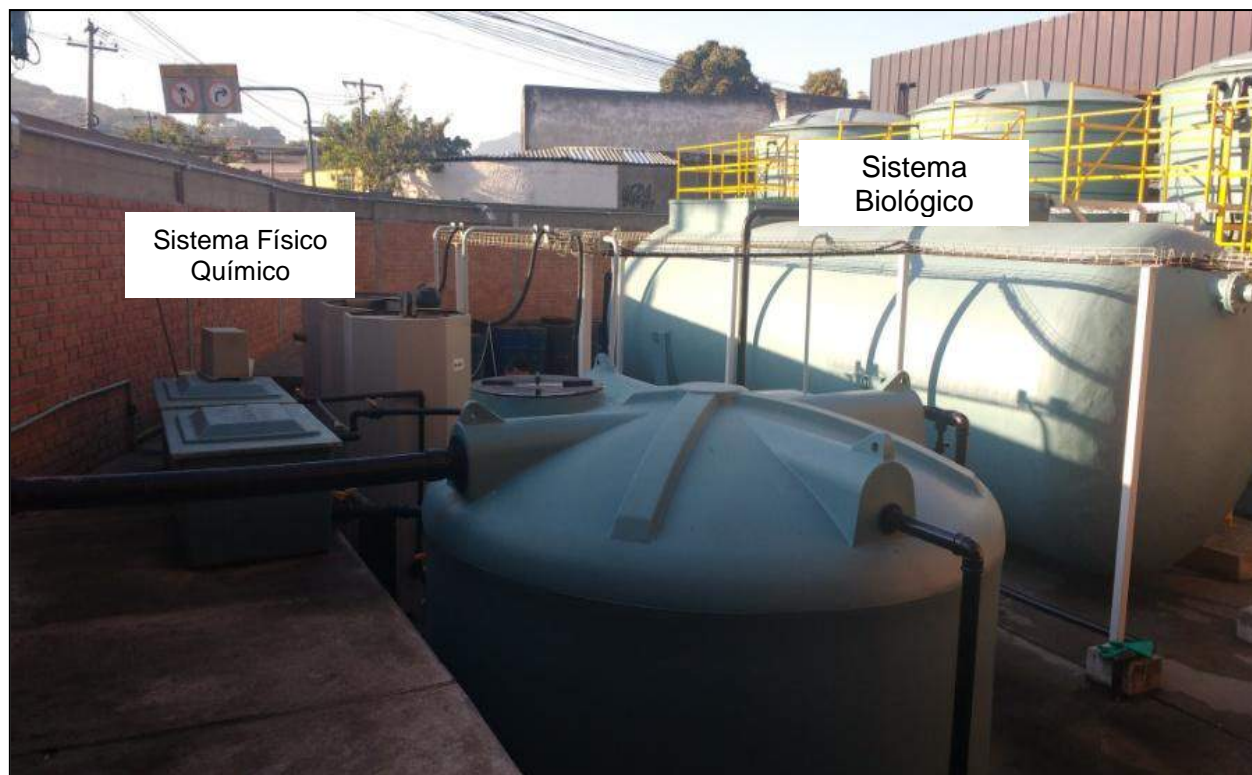
Figura 4.1: Estação de Tratamento de Efluentes da IBMA(Fonte Própria).
