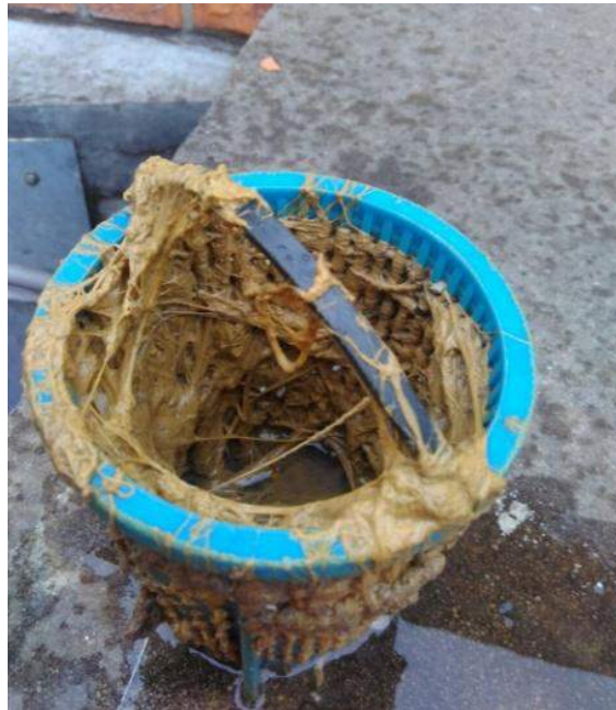
Figura 5.12: Filtro da bomba de alimentação do sistema físico químico da ETE (Fonte própria)
