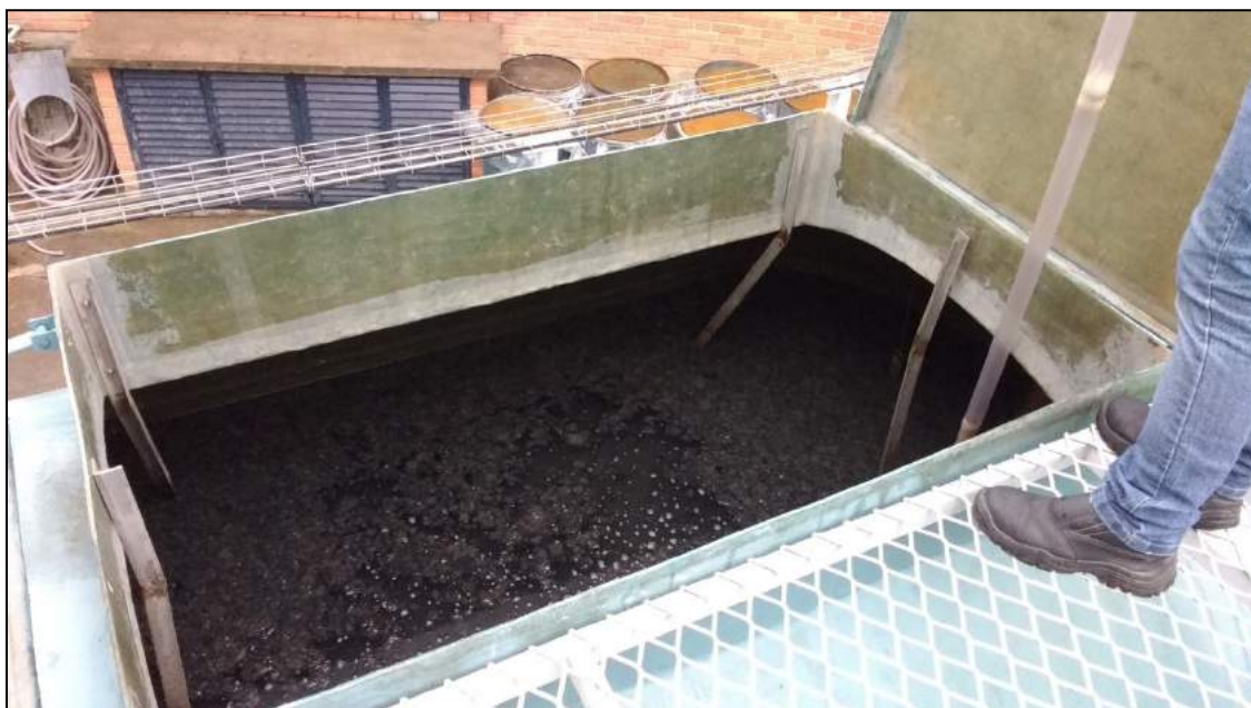
Figura 4.8: Decantador Biológico - Tanque 804 (Fonte Própria)
