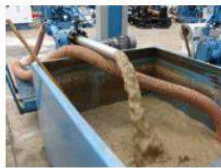
Drenagem de Lago
