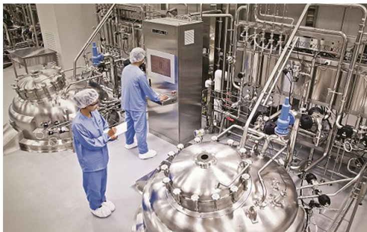
Figura 13: Planta industrial farmacêutica construída em aço inoxidável. Fonte: ME Tenders. Disponível em https://metenders.com/project_cms/project/pharmaceutical-manufacturing-plant-project .
