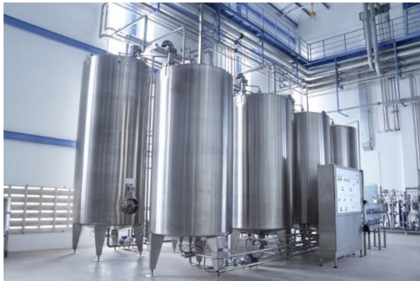
Figura 30: Tanques de armazenagem de água quente, feitos em aço inoxidável duplex. Fonte: Western Stainless. Disponível em: http://www.westernstainless.com.au/understanding-duplex-stainless-steel/
