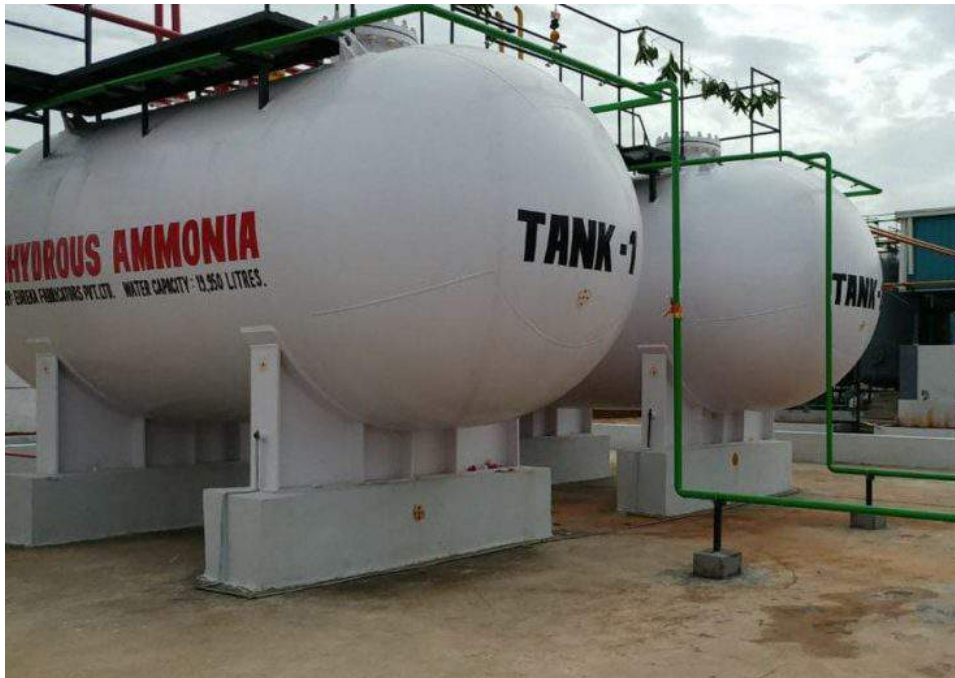
Figura 13 – Tanque cilíndrico horizontal de amônia
