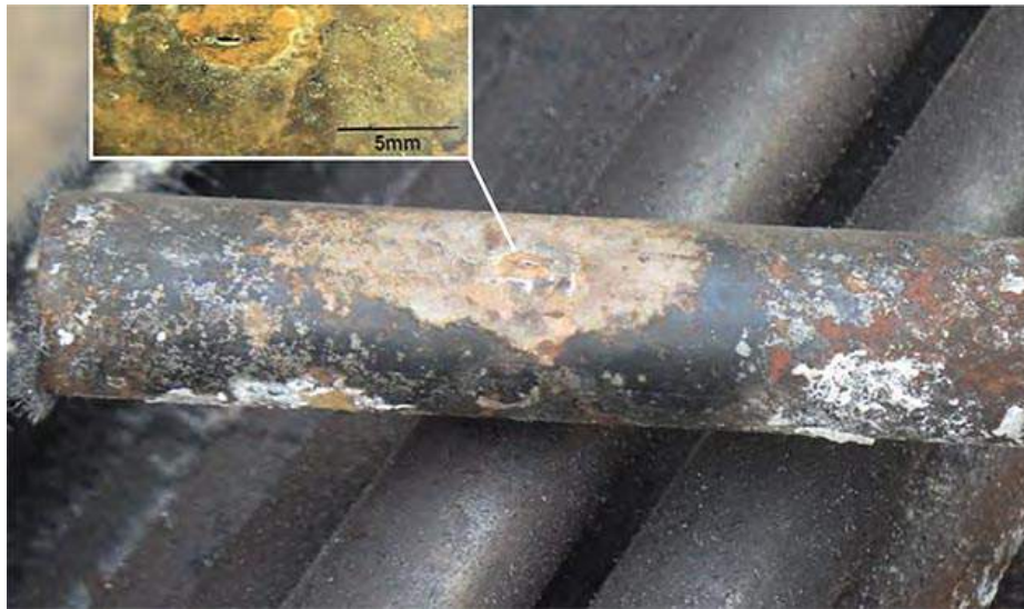
Figura 41 – Furo causado pela corrosão em um dos tubos do chiller
