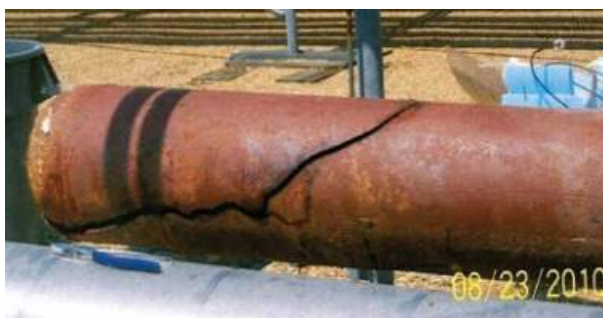
Figura 30 – Tubulação rompida no teto da instalação da Millard Refrigerated Services
