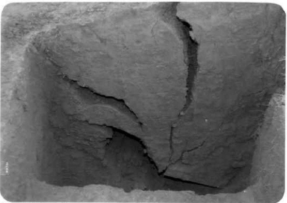
Fig.IV.4 - Desenvolvimento do processo de ruptura na fundação F
