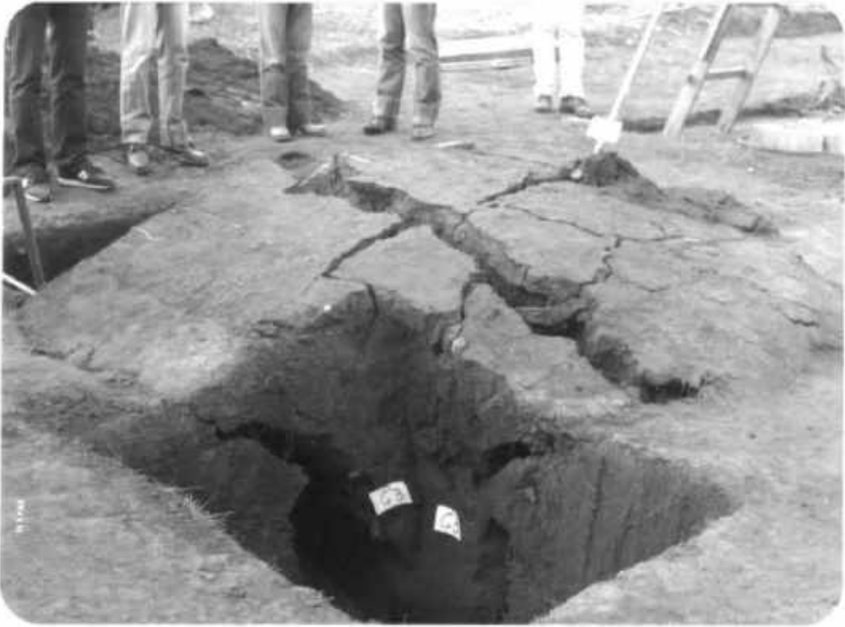
Fig.IV.5 - Intumescimento ocasionado pela ruptura (fundação H)
