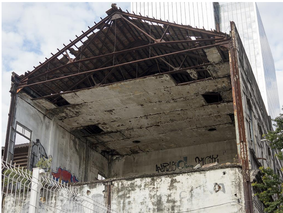
8. Galpão abandonado na Av. Venezuela. Ao fundo novo empreendimento, espelhado. Foto: Angelo A Duarte
