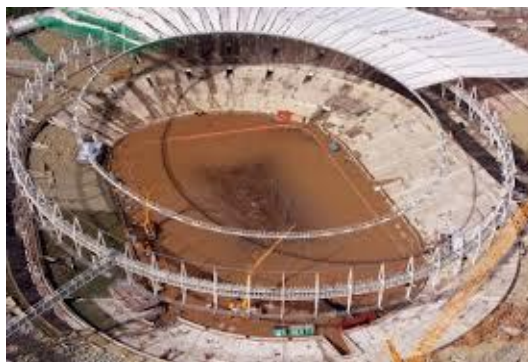
Figura 4.2. Estádio Maracanã alagado. Fonte: G1. http://g1.globo.com/rio-de-janeiro/noticia/2013/03/prefeitura-pede-para-cariocas-ficarem-em-casa-devido-temporal-no-rio.html .
