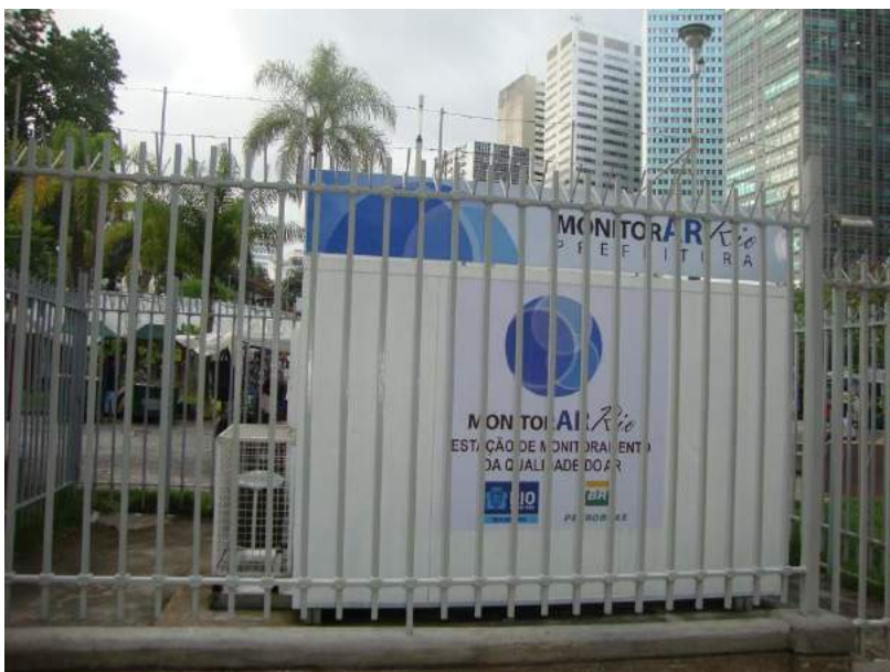
Figura 21: Estação de monitoramento - Centro (SECONSERMA).
