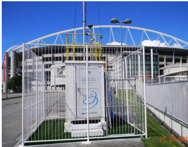
Figura 19: Estação de monitoramento - Engenhão.
