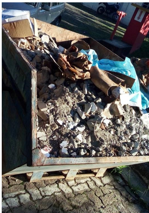
Figura 16 - Entulho de obra Fonte: Acervo pessoal, 19/05/2017
